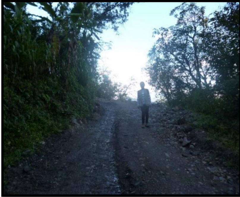
Imagen 7: Derrumbes y charcos de agua en la vía
