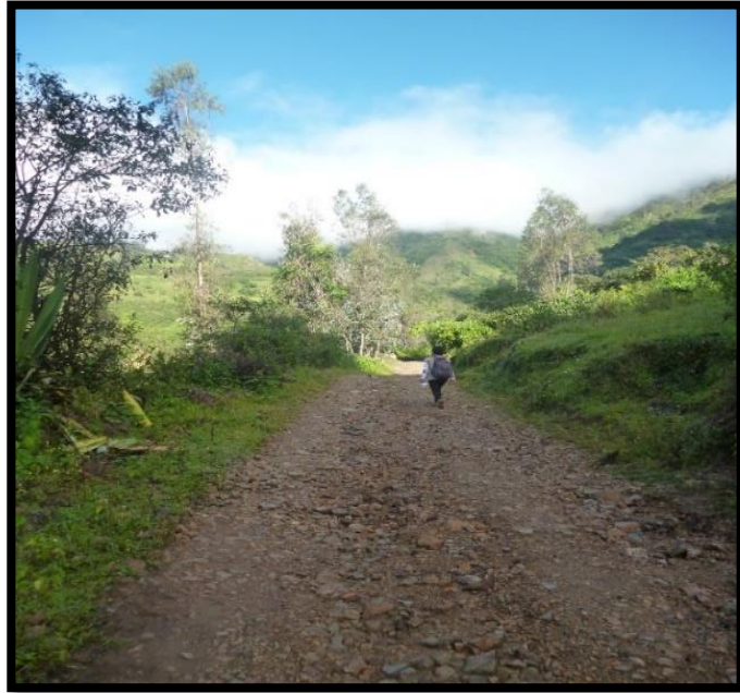
Imagen 5: Desgaste de la superficie de rodadura
