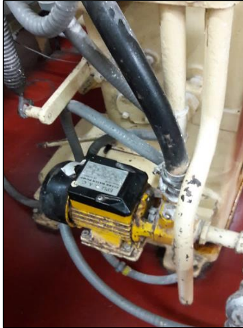
Sistema de tubería y bomba del Tanque diluidor de manteca
