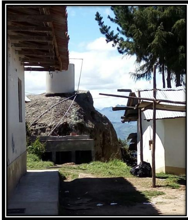
Figura 7: Reservorio con tuberías expuesta y en mal estado.
