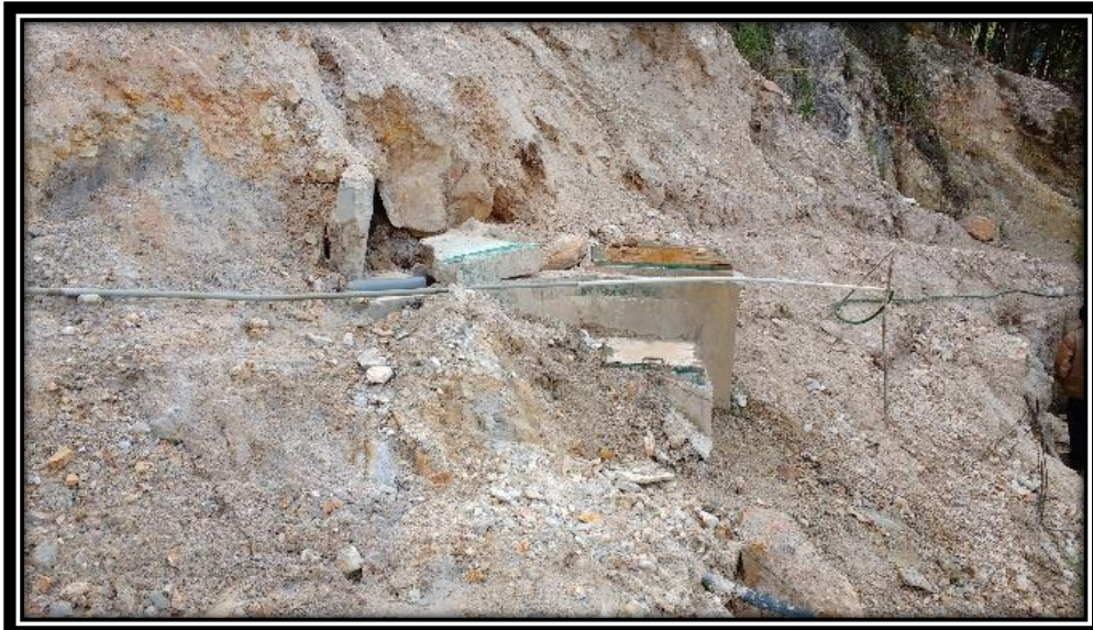
Figura 4: Captación en mal estado
