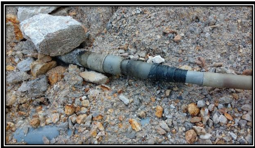
Figura 6: Tubería reparada artesanalmente, que presenta fugas
