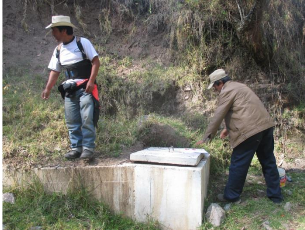
PRIMERA CAPTACION Y ENESTADO DE DETERIORO
