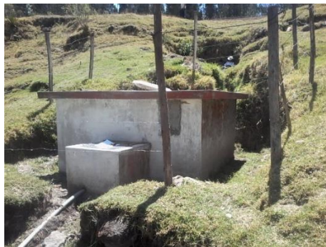
RESERVORIO QUE RECIBE DE DOS CAPTACIONES
