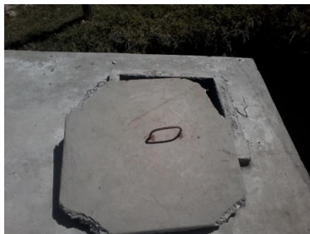
TAPA DETERIORADA DEL RESERVORIO PRIMARIO
