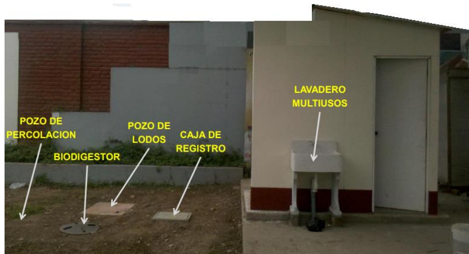
Figura 24.- Sistema de descarga vista aérea
