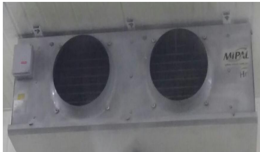
Fotografía cámara frigorífica interna, de la empresa Newrest Inflight S.A.C.
