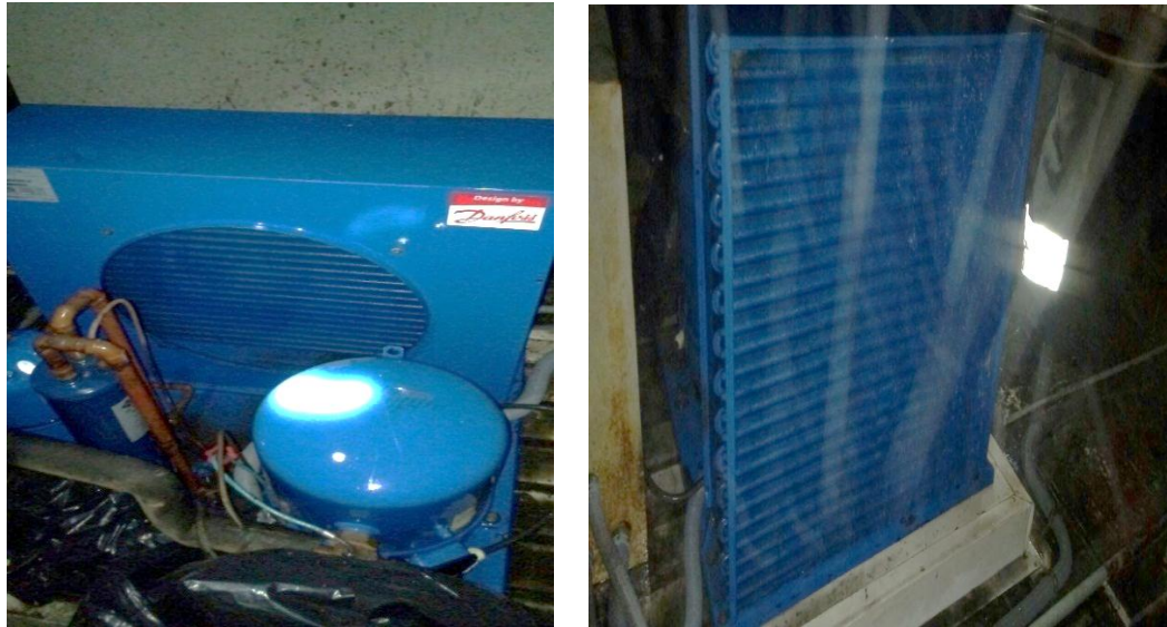
Fotografía cámara frigorífica externa, de la empresa Newrest Inflight S.A.C.
