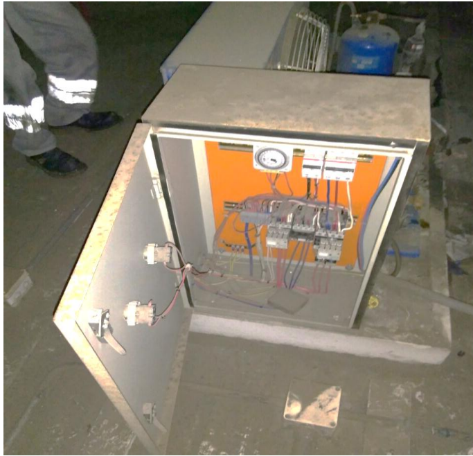
Fotografía cámara frigorífica parte externa, de la empresa Newrest Inflight S.A.C.
