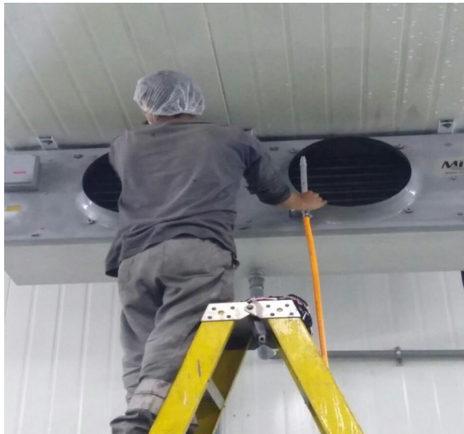
Fotografía cámara frigorífica parte interna, de la empresa Newrest Inflight S.A.C.
