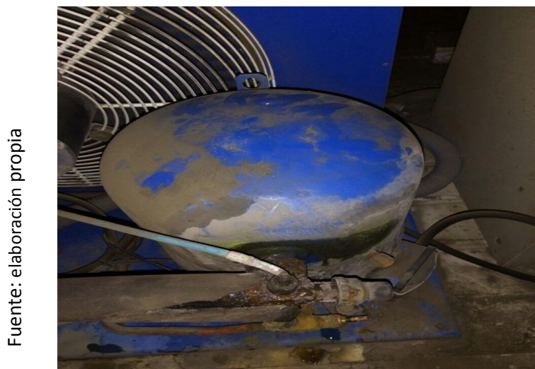
Figura 12. Compresor a falta de mantenimiento
