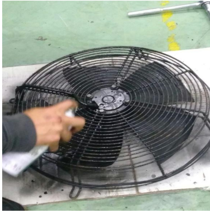
Fotografía cámara frigorífica parte interna, de la empresa Newrest Inflight S.A.C.
