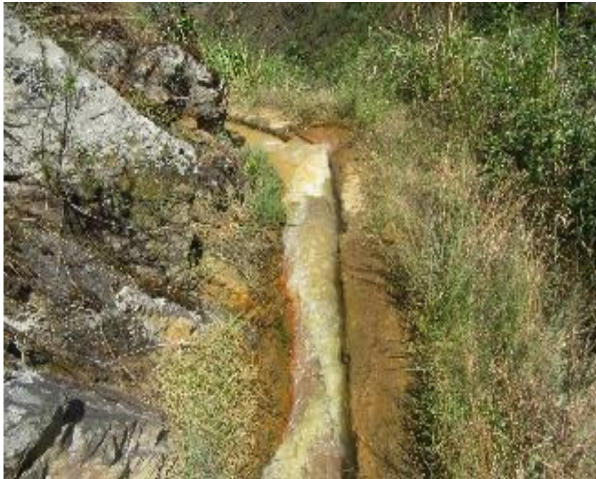
TRAMO DE CANAL CON ELEVADA PENDIENTE SIN DIMENSIONES GEOMÉTRICAS ADECUADAS
