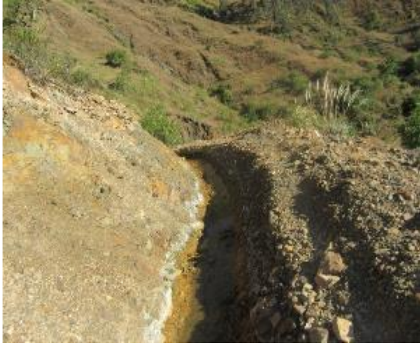
TRAMO DE CANAL CON ELEVADA PENDIENTE PRODUCIENDO EROSIÓN
