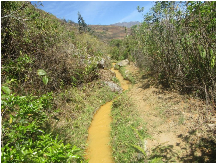
TRAMO DE CANAL CON PROBLEMAS DE FILTRACIÓN
