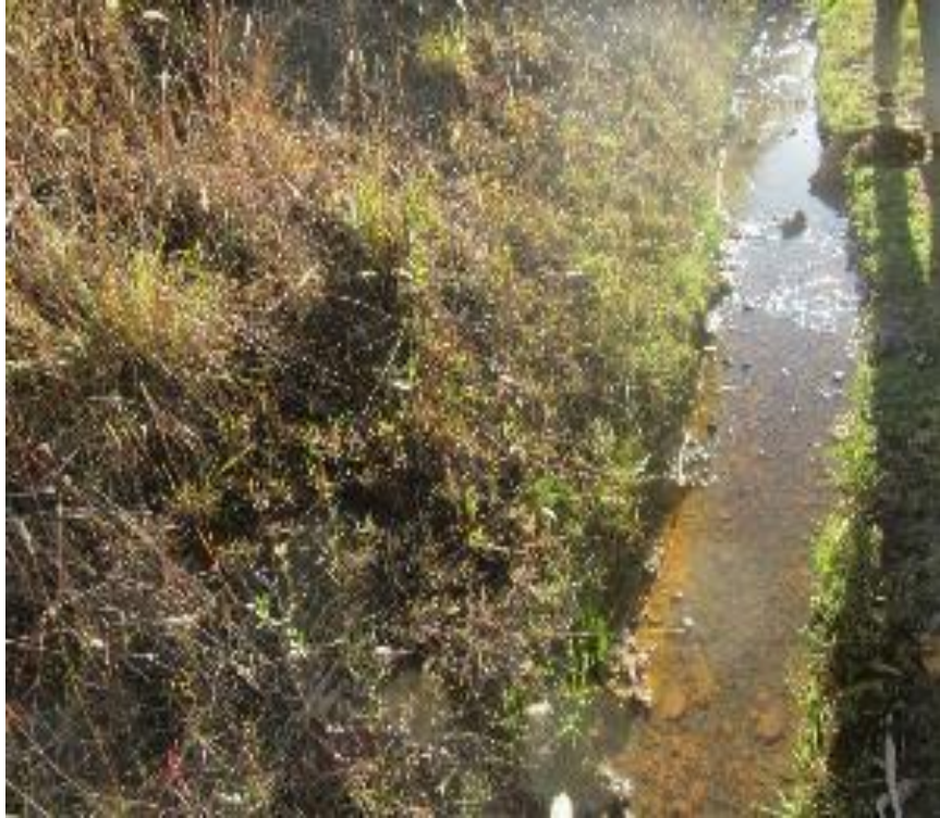
TRAMO DE CANAL CON PROBLEMAS DE ESTANCAMIENTO
