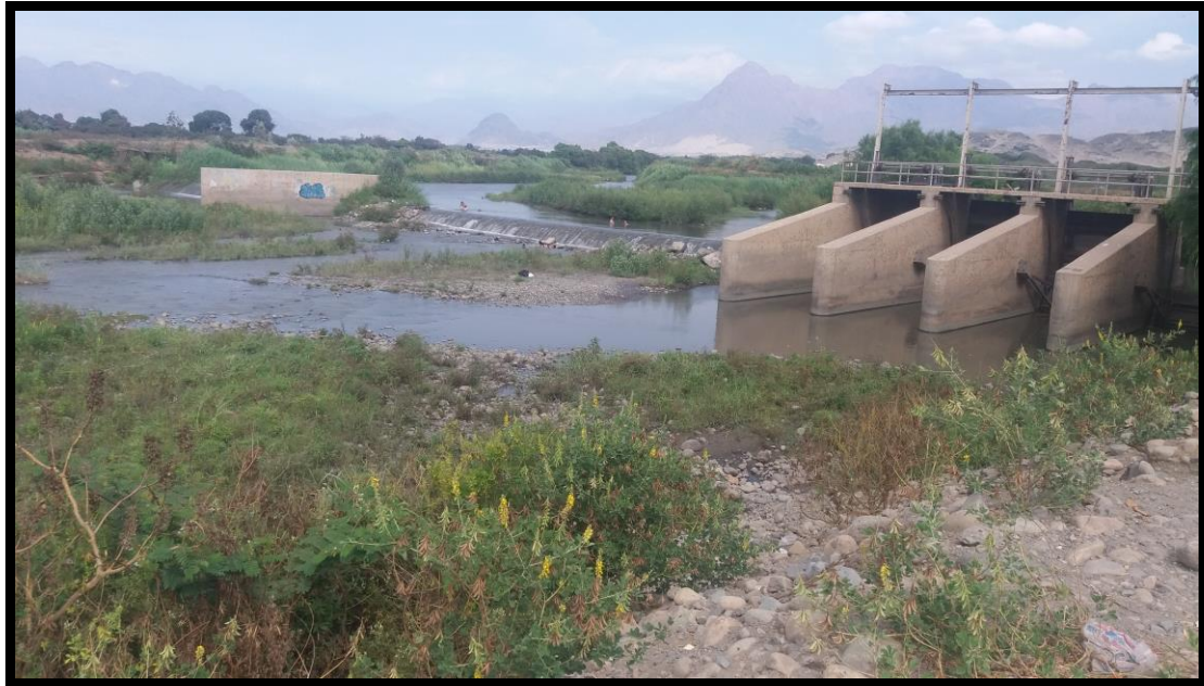
FOTOGRAFÍA 06: Instalación hidráulica de captación de agua de riego Bocatoma Santa Lucía en el río Moche en la jurisdicción del distrito de Moche
