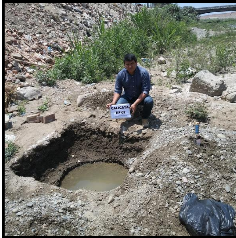
FOTOGRAFÍA 22: Excavación de la calicata # 07 en la cuenca del río Moche en la jurisdicción del distrito de Moche
