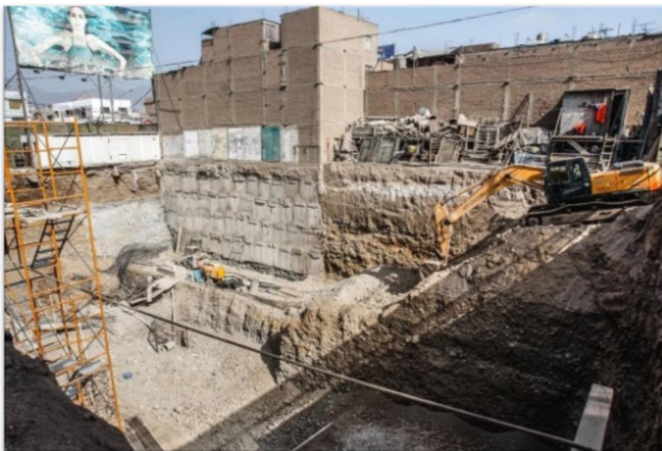
Figura 3: Accidente por deslizamiento en plano de falla 2
