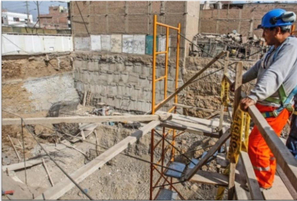
Figura 2: Accidente por deslizamiento en plano de falla 1
