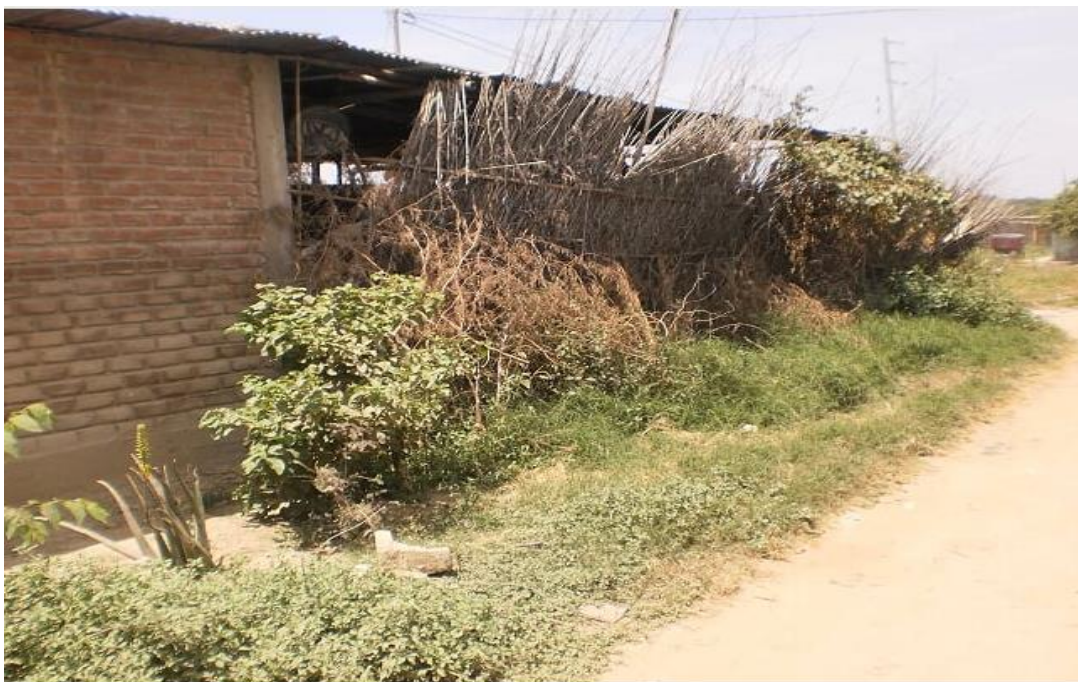
Figura 10. Colapso de pared lateral Fuente: Elaboración propia
