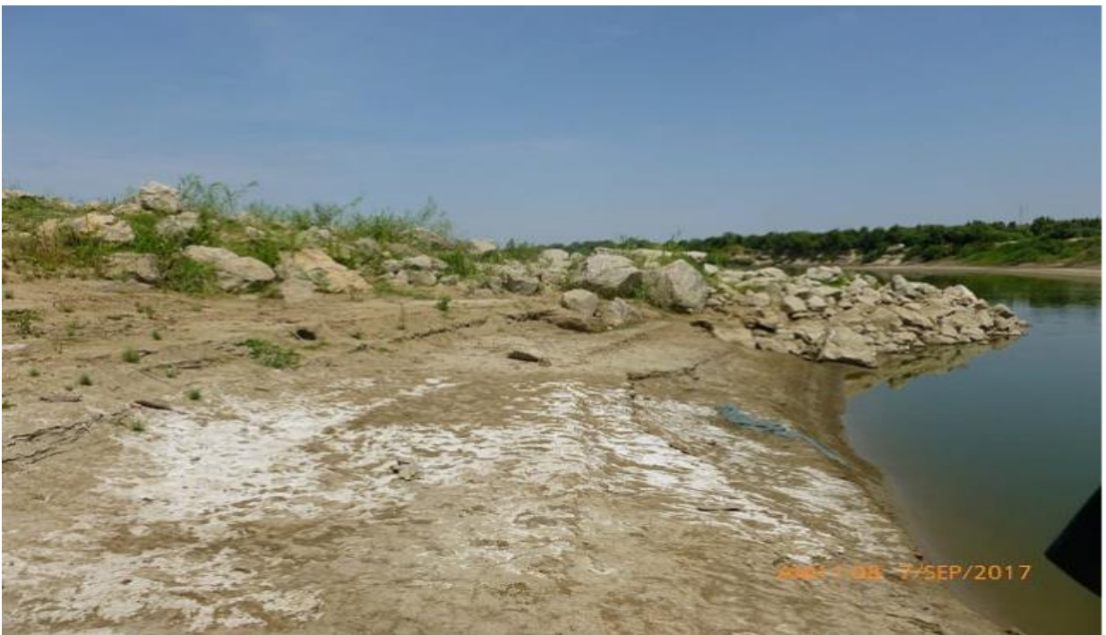
Figura 15. Colapso de dique Fuente: Elaboración propia
