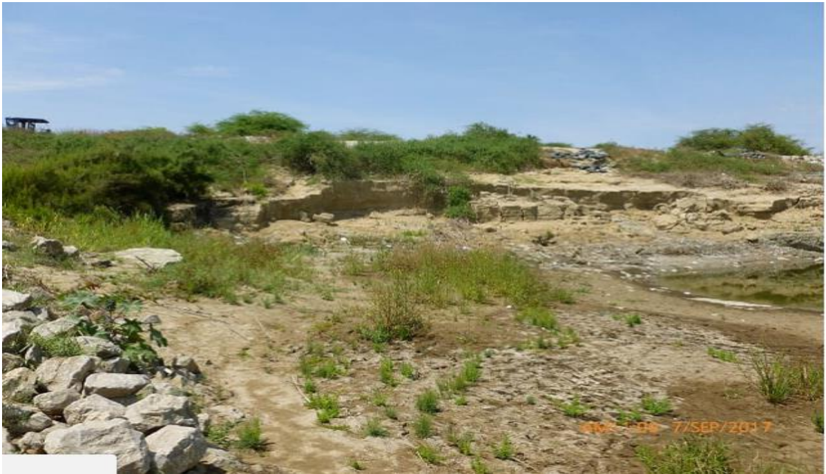
Figura 18. Colapso de la defensa del río Fuente: Elaboración propia
