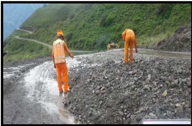
Figura 2: Caída de derrumbe
