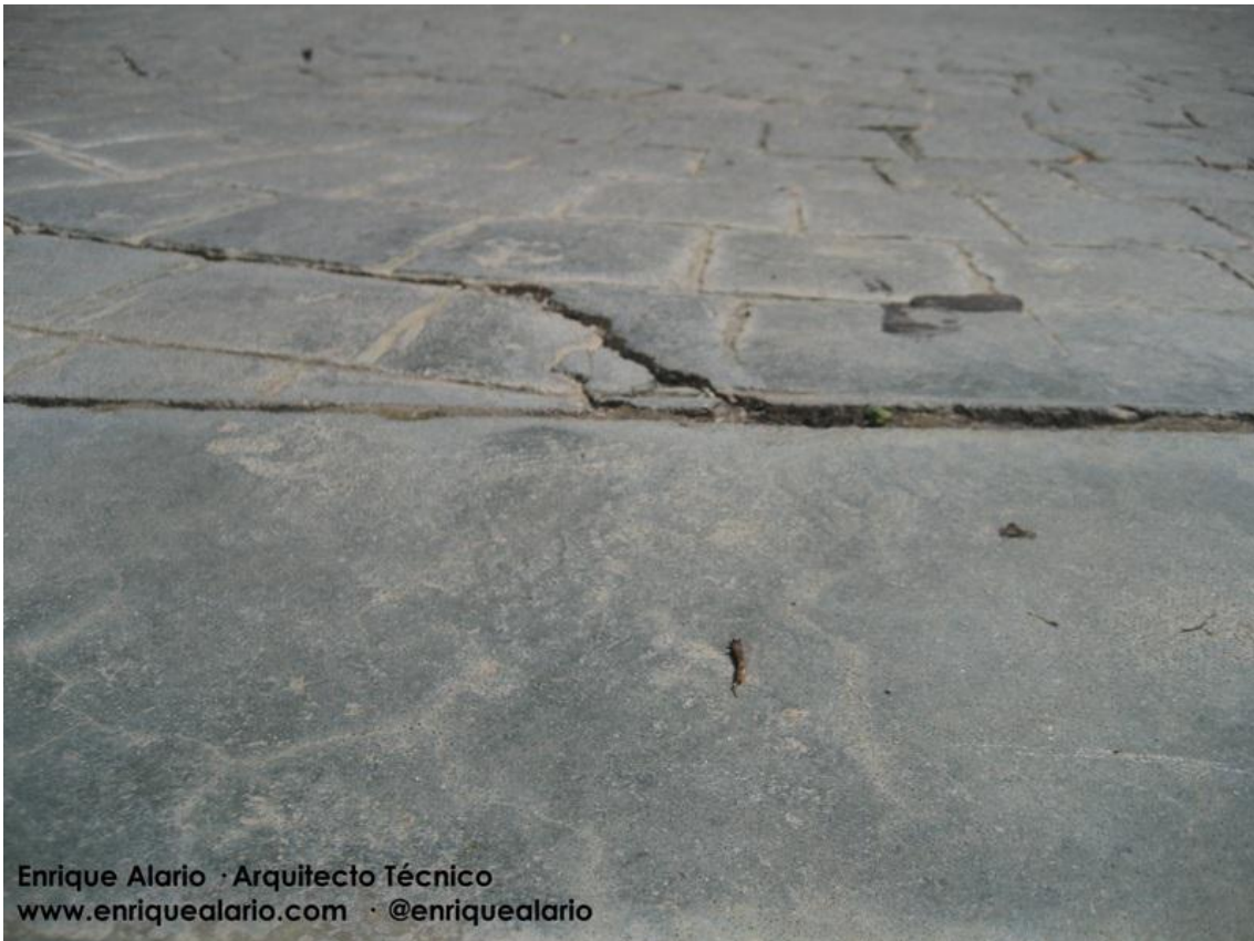
Figura 02. Losa de piso de tránsito pesado sin fibras de acero. Fuente: propia
