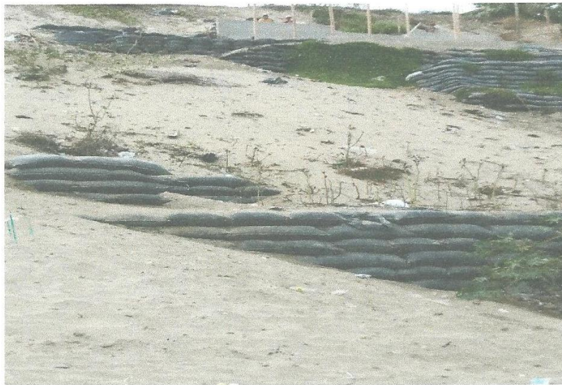
En la imagen se observa presencia de sacos como protección a deslizamientos por ser inestables
