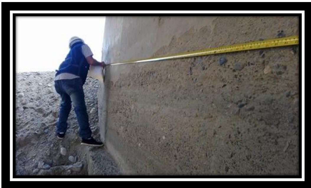
La subestructura del puente antiguo fue colapsada por la mitad
