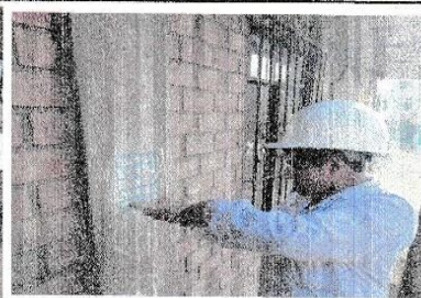
FOTO N° 2 : COLUMNA C2 UBICADO EN EL 1ER PISO EJE A-A/3-3, SE UBICA A LA IZQUIERDA DE LA VENTANA DE LA SALA
