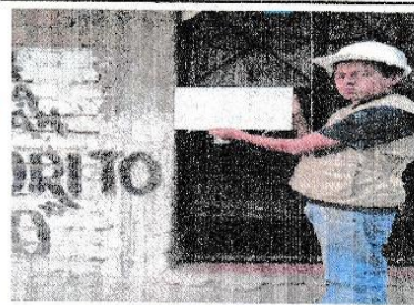
FOTO N° 2: COLUMNA UBICADO EN EL 2DO PISO EJE B-B/1-1, SE UBICA EN LA PUERTA DE TRAS DE LA SALA DEL SEGUNDO PISO
