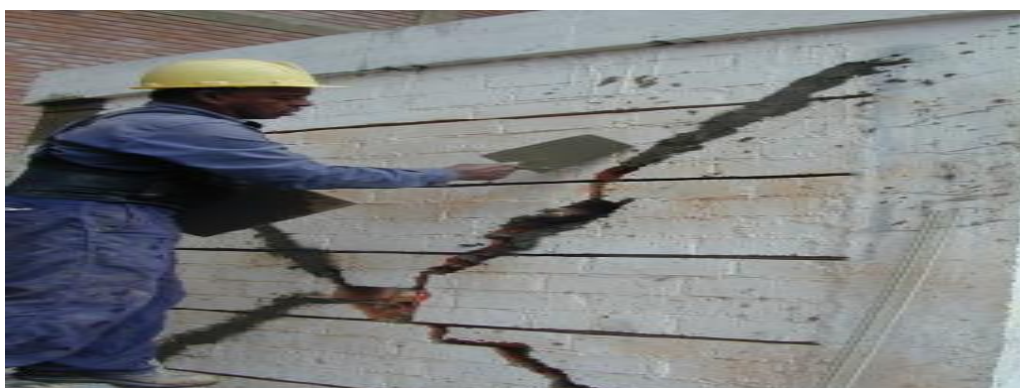
Figura 120. Resanar el muro con mortero de reparación SIKA o convencional (Fuente: Loayza 2008)
