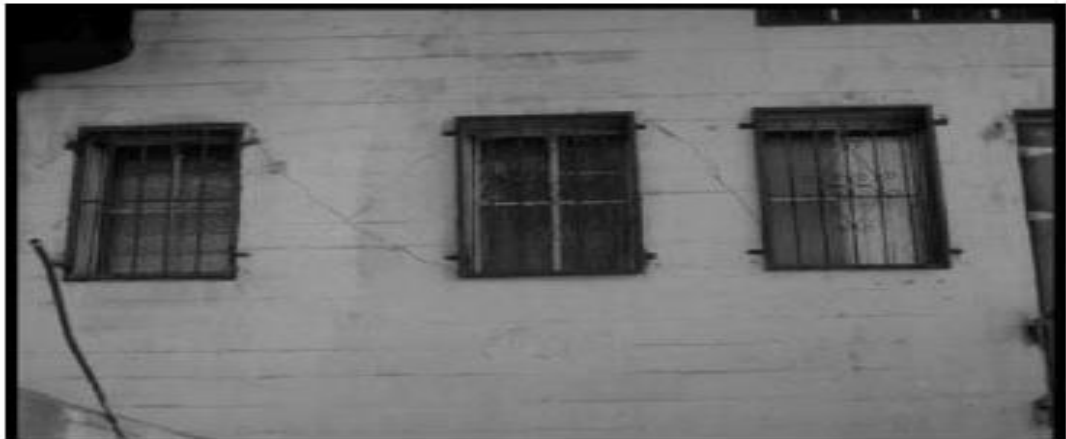
Figura 10. Grietas formadas por tensión diagonal (Fuente: Giraldo y Méndez 2006)
