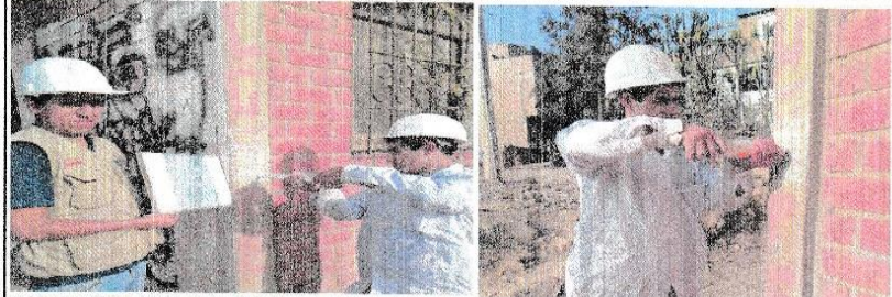
FOTO N° 1 : COLUMNA C2 UBICADO EN EL 1ER PISO EJE A-A/5-5, SE UBICA A LA IZQUIERDA DE LA PUERTA PRINCIPAL
