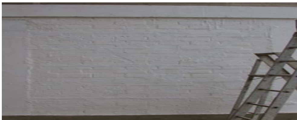
Figura 123. Muro reparado ( Fuente: Loayza 2008)
