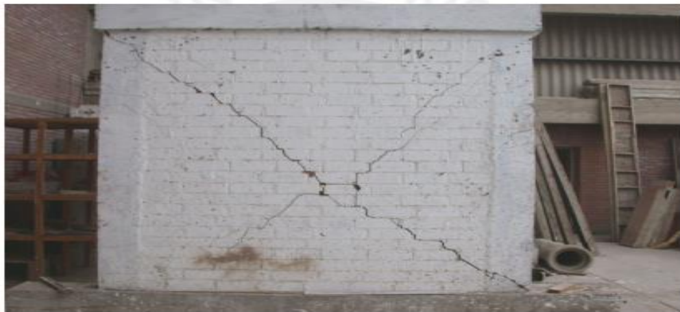
Figura 116. Antes de la reparación (Fuente: Loayza 2008)
