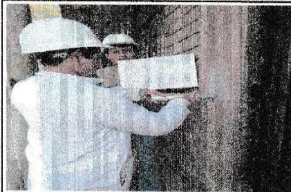
FOTO N° 1: COLUMNA C2 UBICADO EN EL 1ER PISO EJE A-A/4-4, SE UBICA A LA IZQUIERDA DE LA PUERTA SECUNDARIA
