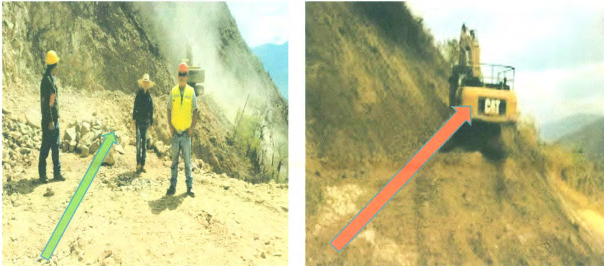
Figura 1. Identificación de riesgos, corte en talud
