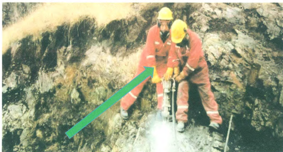
Figura 3. Riesgos de voladuras en zona rocosa Fuente: elaboracion propia 2017
