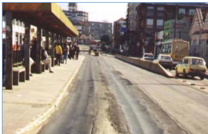
Figura 2. Falla por ahuellamiento.
