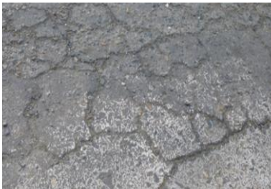
Figura 8. Falla piel de cocodrilo. Fuente: Elaboración propia.
