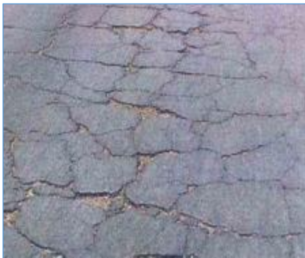
Figura 3. Agrietamiento por fatiga. Fuente: Garnica, Gómez, Sesma (2002).
