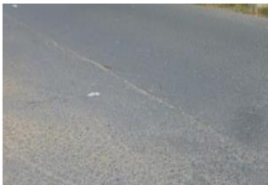
Figura 9. Fisura transversal y longitudinal. Fuente: Elaboración propia.
