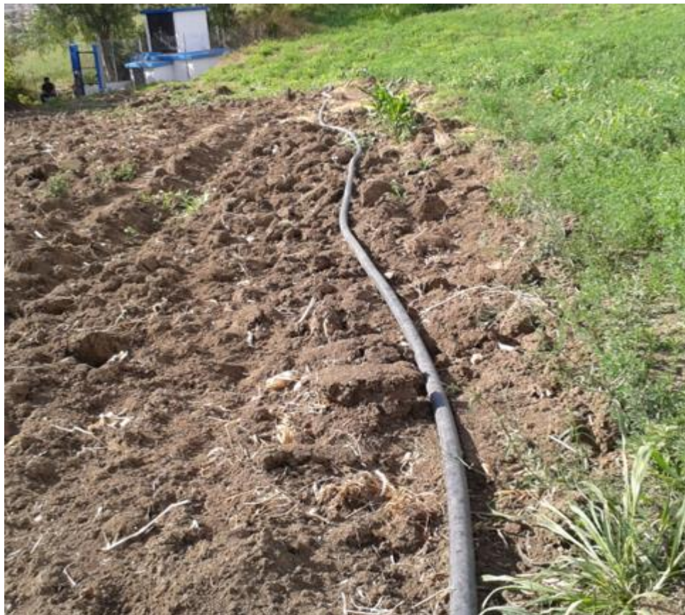
Anexo 31. Estado de línea de conducción
