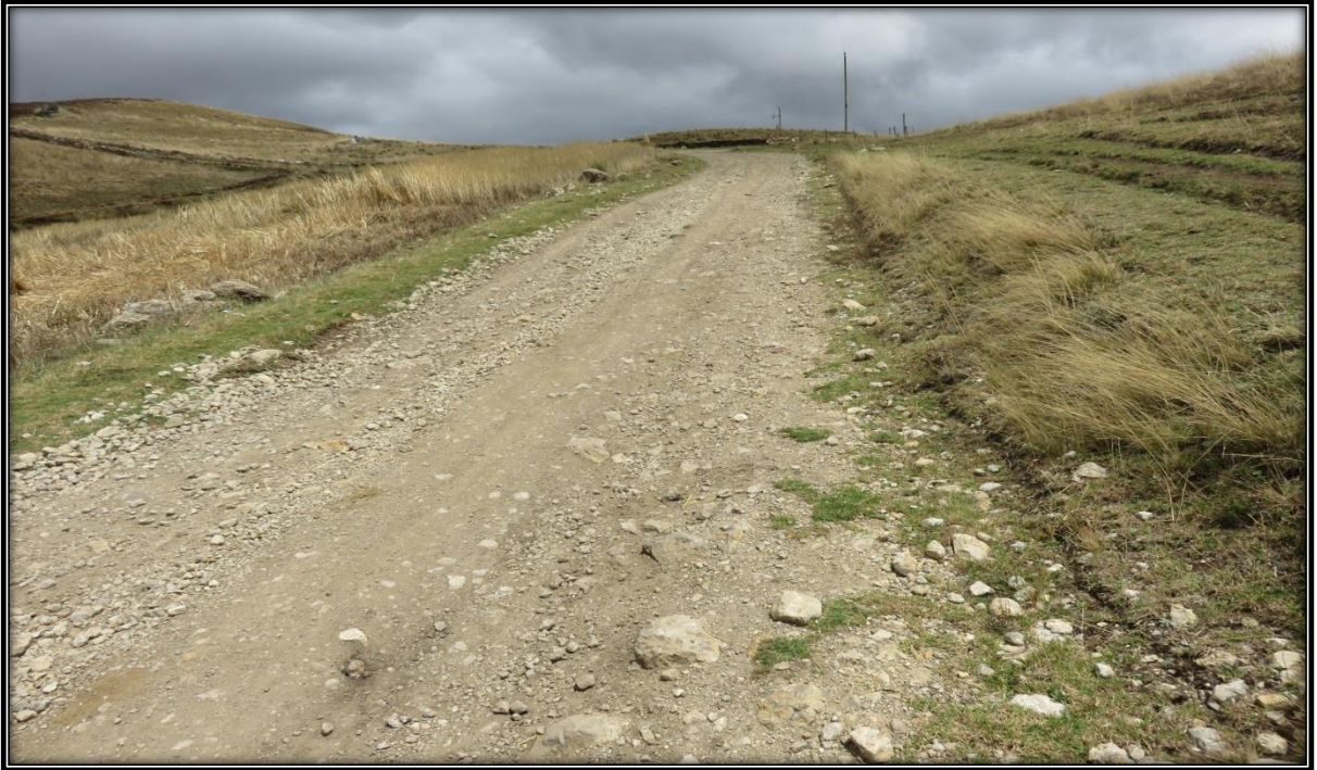
Situación actual de la carretera, se aprecia la falta de cunetas en el tramo longitudinal de la carretera
