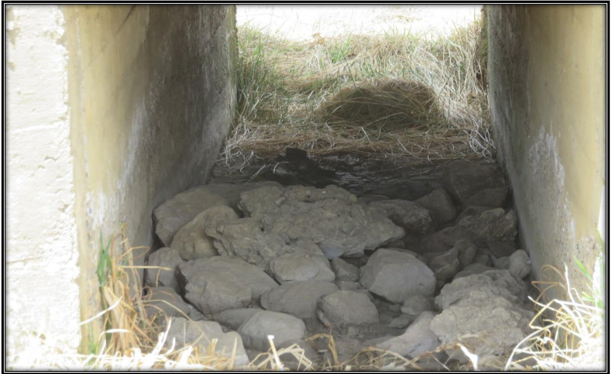
Situación deplorable de las alcantarillas de paso y alivio, mal ubicadas.
