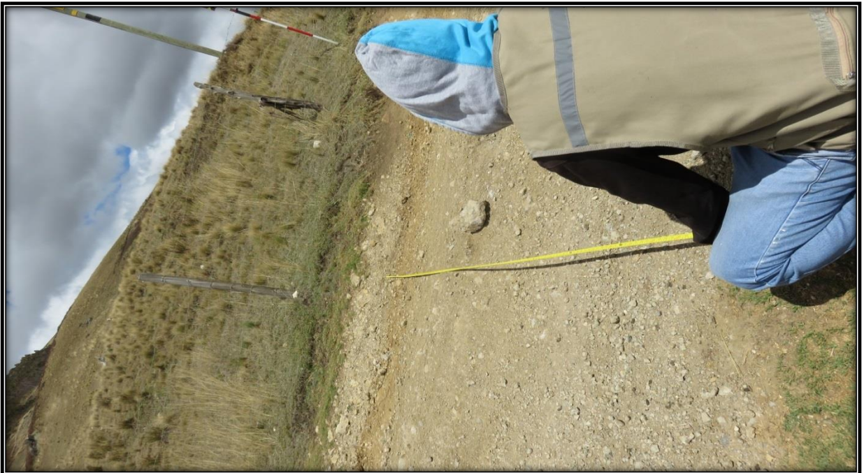
Situación actual de la carretera con un ancho variable y sin cunetas que puedan proteger la plataforma de la carretera.
