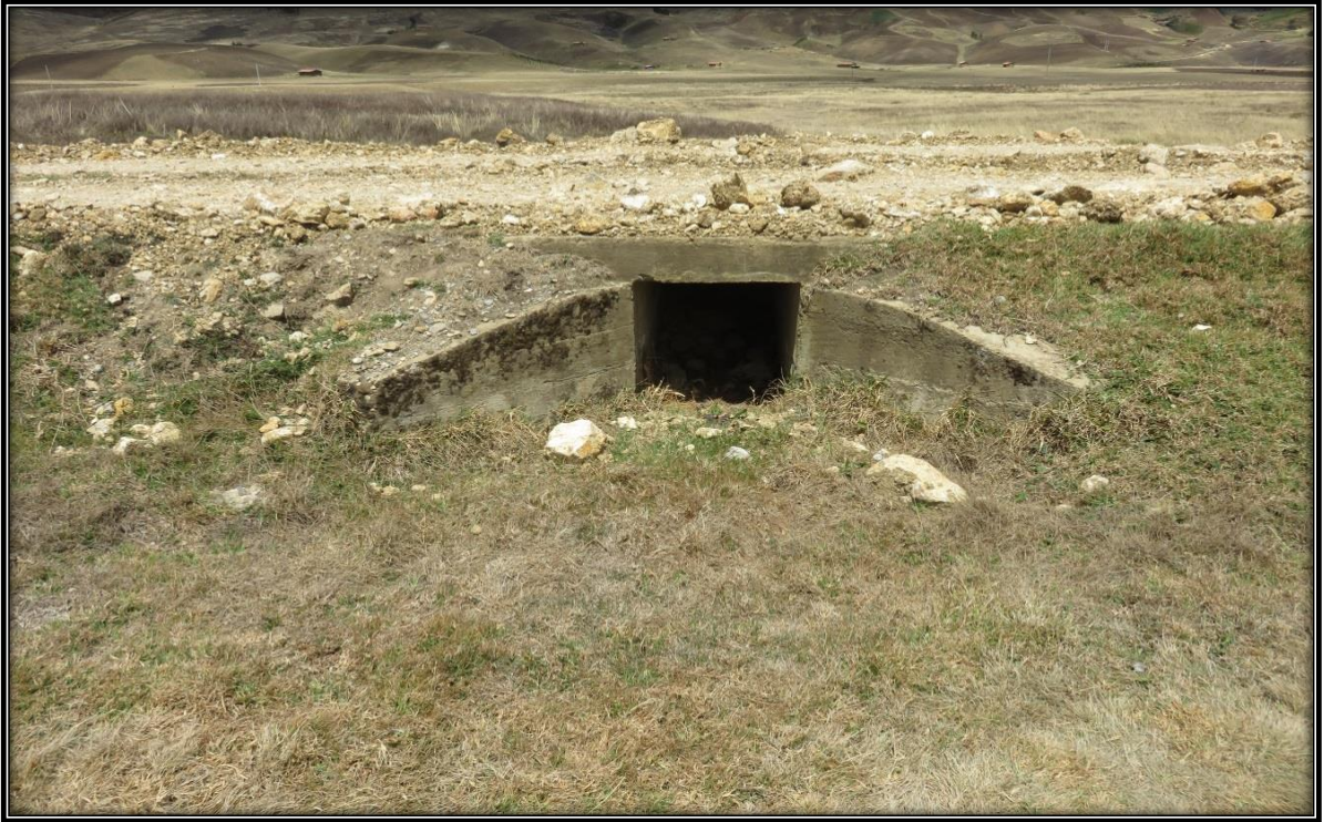
Obras de arte existentes las cuales se encuentran en mal estado en el transcurso del tramo San Juan, Canucubamba u desvío El Progreso.
