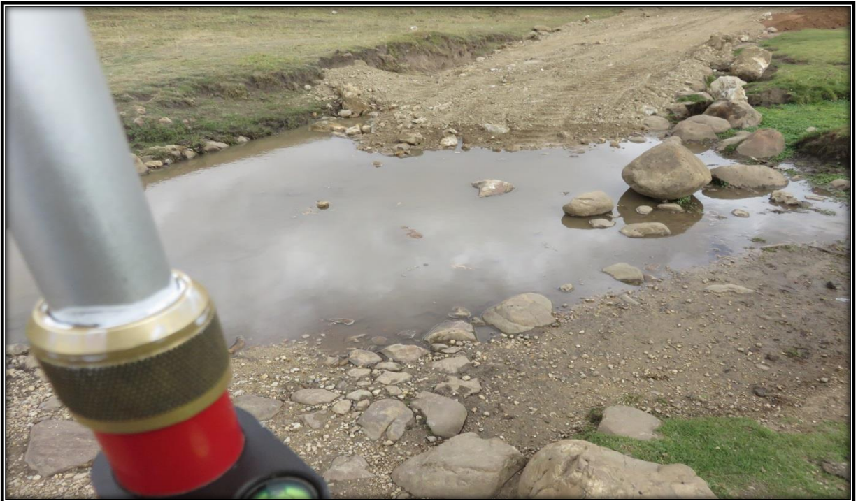
Situación actual de las zonas más críticas de algunos tramos de la carretera, lo cual con el estudio se busca implementar obras de arte.
