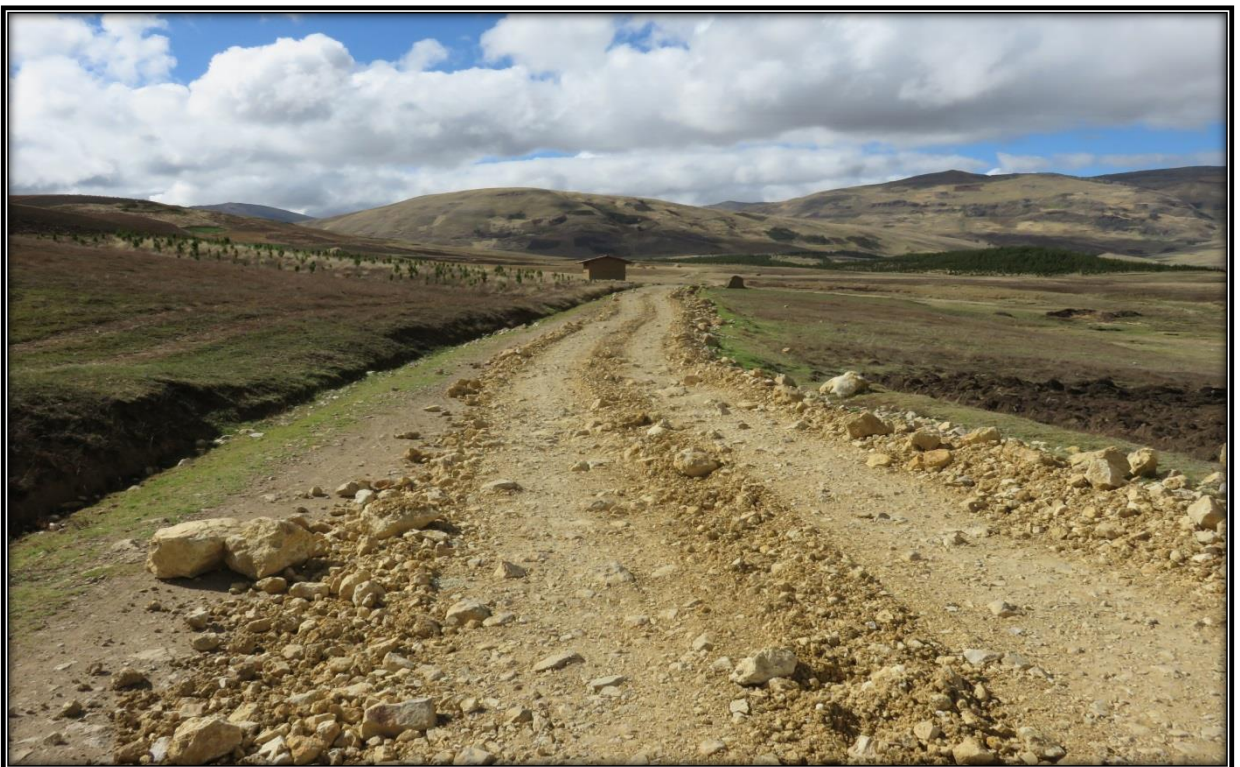
Situación actual de la carretera, se aprecia la falta de cunetas y la plataforma en un mal estado.
