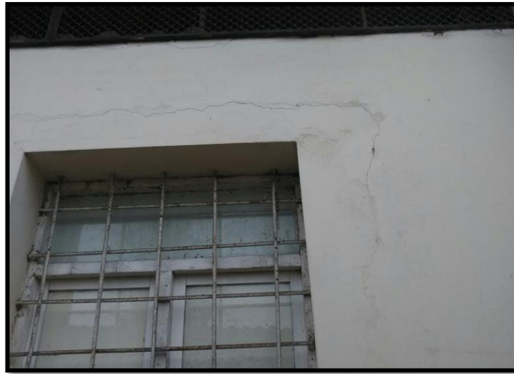
Figura 122: Fisura sobre dintel Fuente: Elaboración propia
