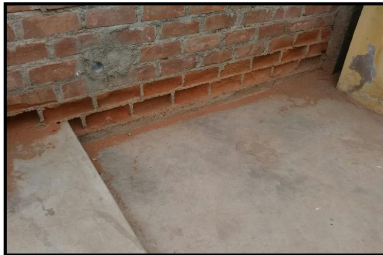
Figura 119: Cerco perimétrico afectado por la humedad Fuente: Elaboración propia
