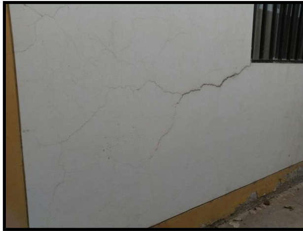
Figura 120: Falla por tracción diagonal
