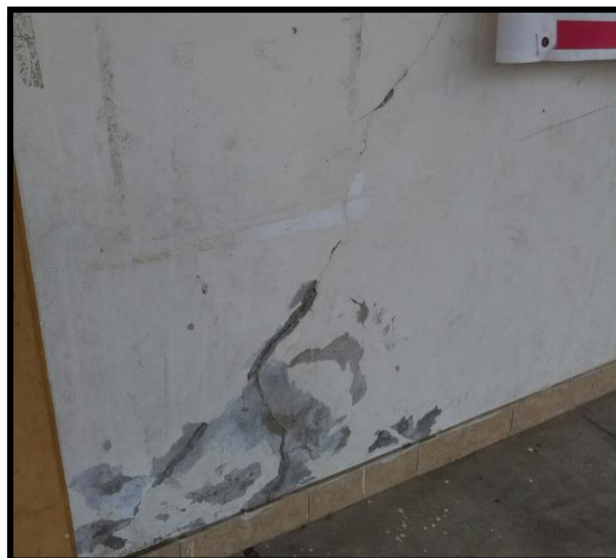
Figura 121: Falla por tracción diagonal
