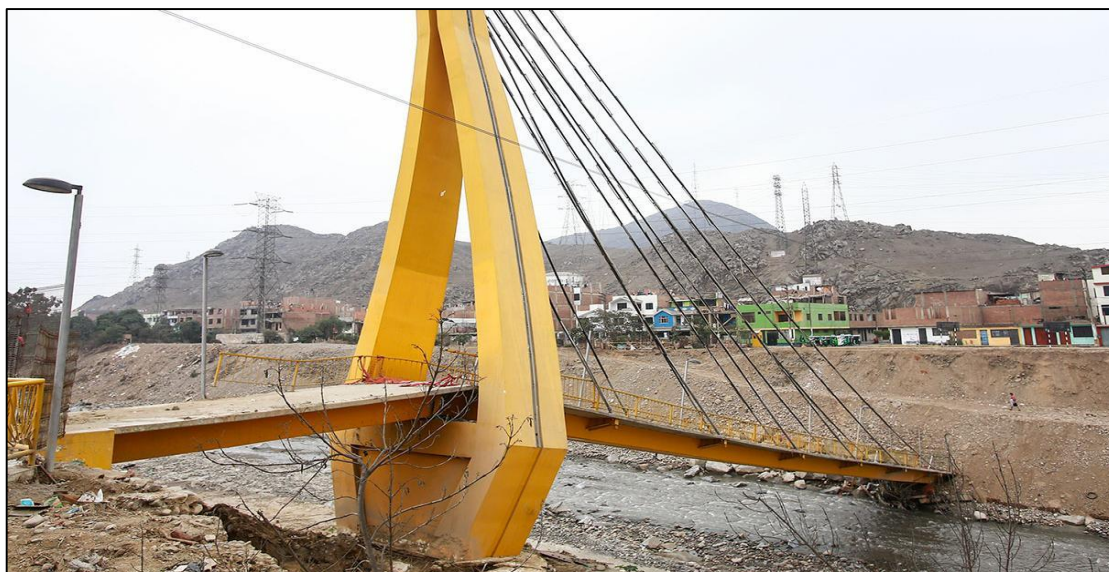
Figura 1.1: falla del puente Solidaridad a consecuencia de la socavación de su talud Fuente: El Comercio, 2017
