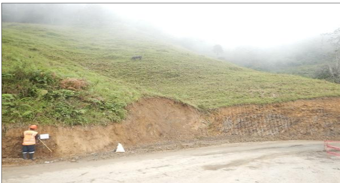
Figura 3.4: vista del talud superior inestable y parte de la plataforma.
