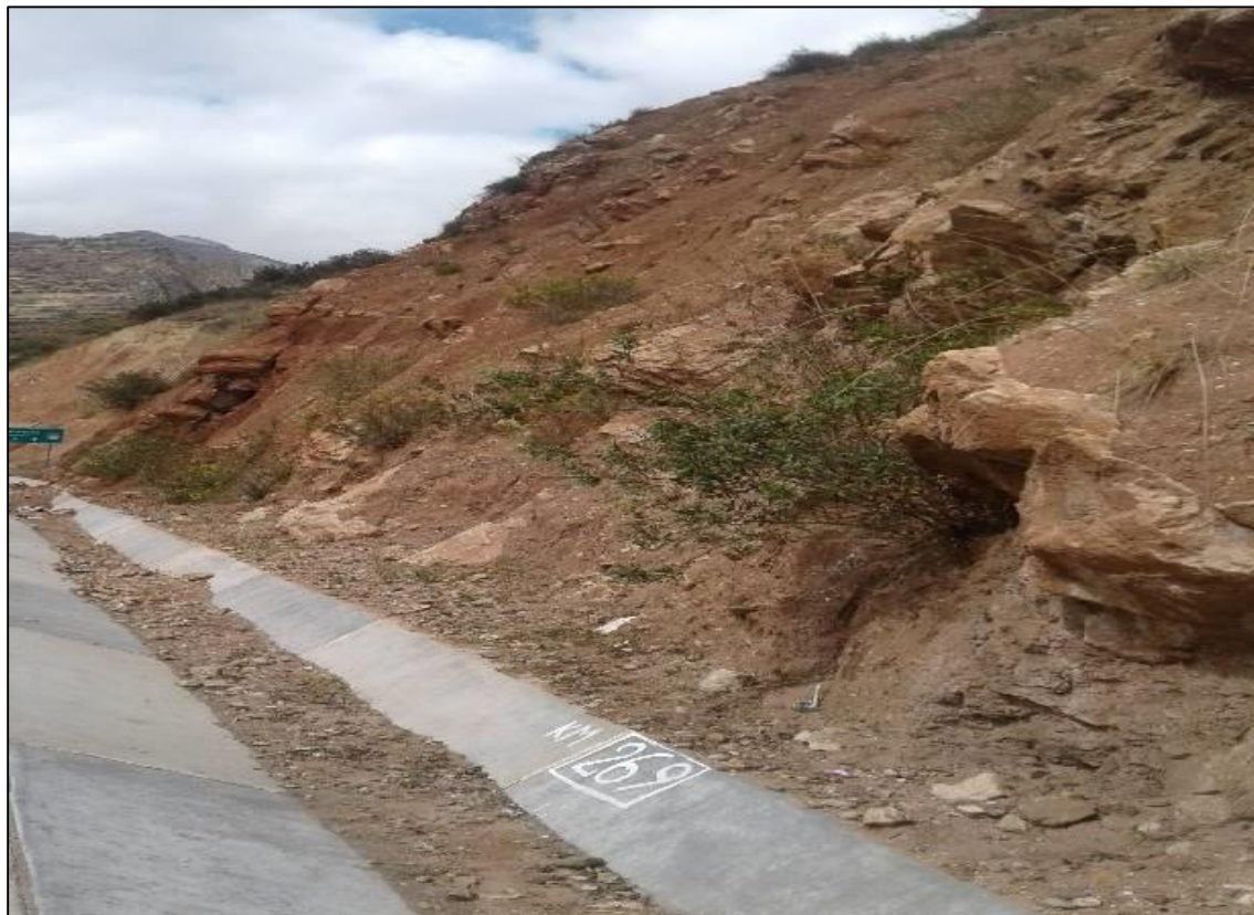
Foto N° 7: Presencia de deslizamiento de suelo sobre la cuneta y vía existente.
