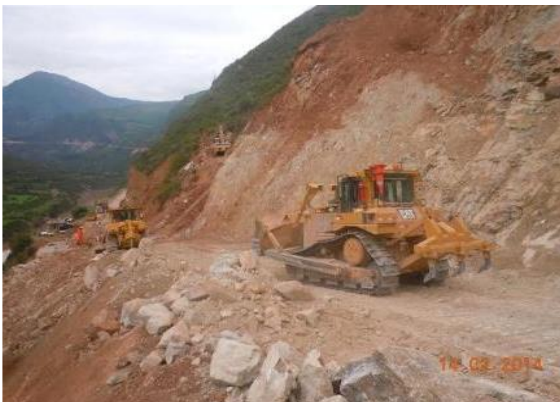
Figura N° 1: Deslizamiento de piedras progresiva 90+000 – 100+000, vía Huancayo Huancavelica. Fuente: Fotografía propia.
