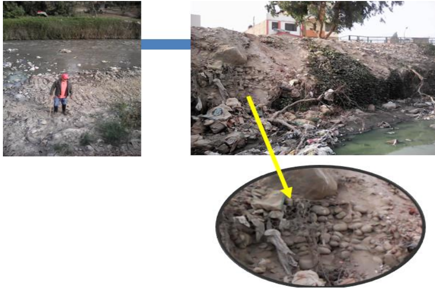
Figura 16. Estado actual de las defensas ribereñas. (Fuente: Imagen propia, 2018)
