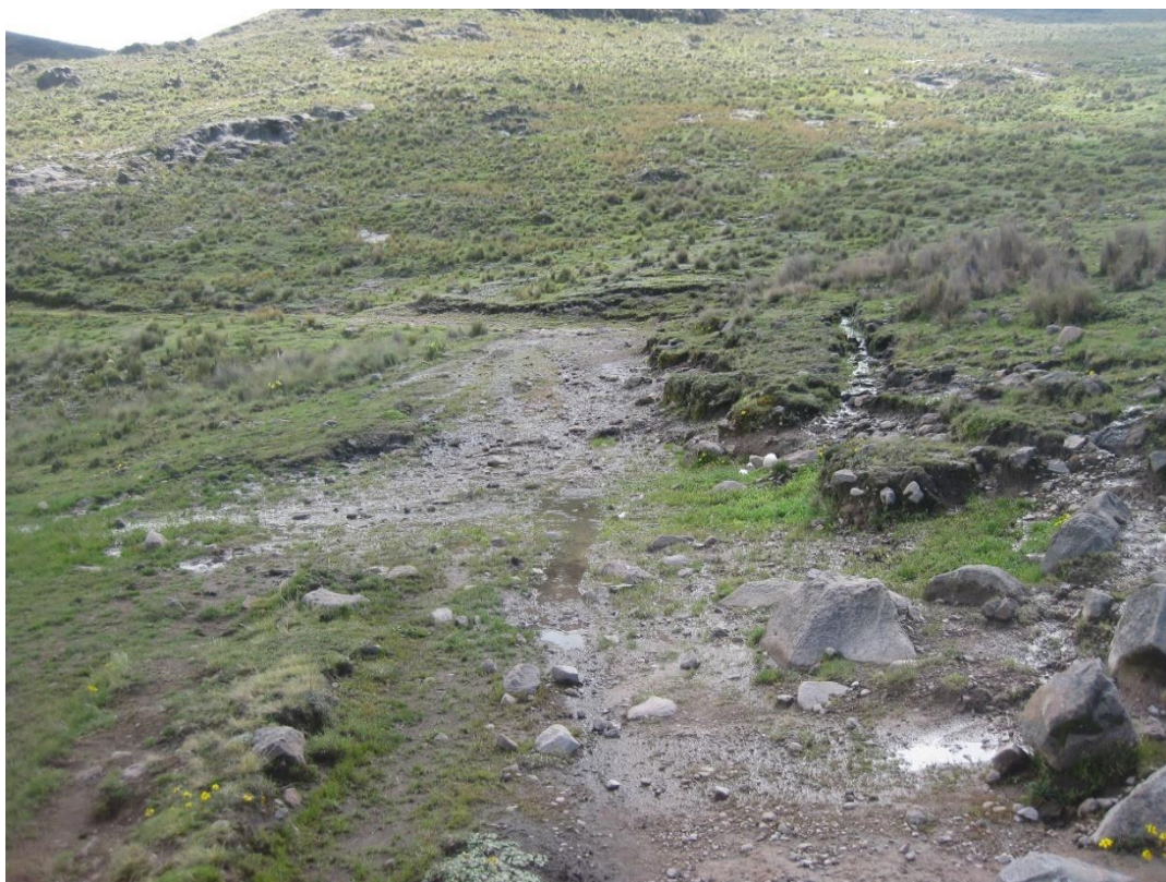
Figura 18. Estado del camino en épocas de lluvia.
