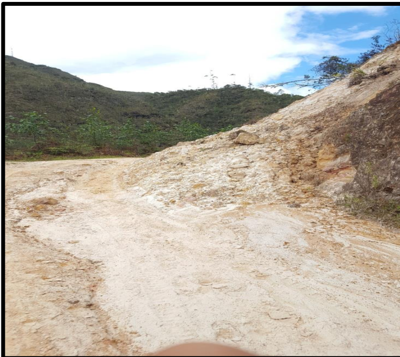
Imagen 4: punto inicial de la carretera anexo Nuevo Luya.
