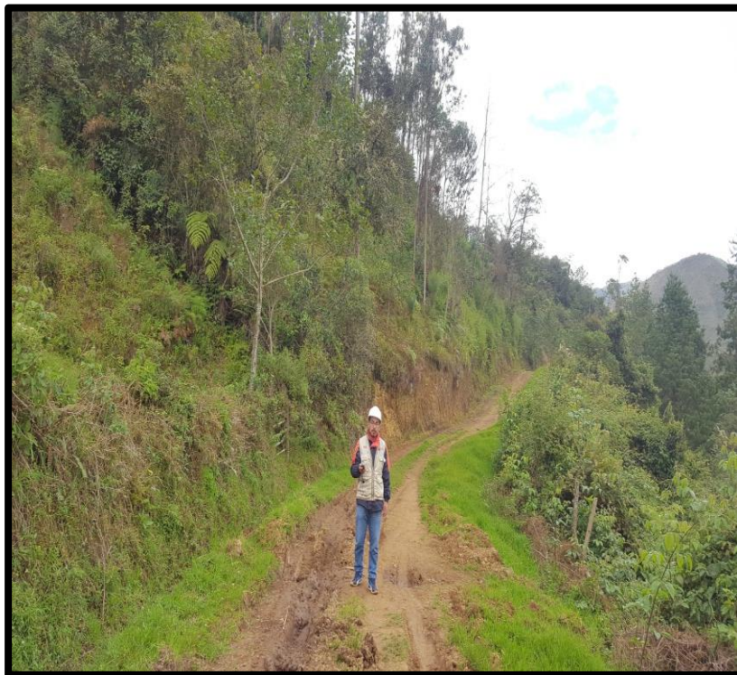
Imagen 2: estado actual de la carretera
