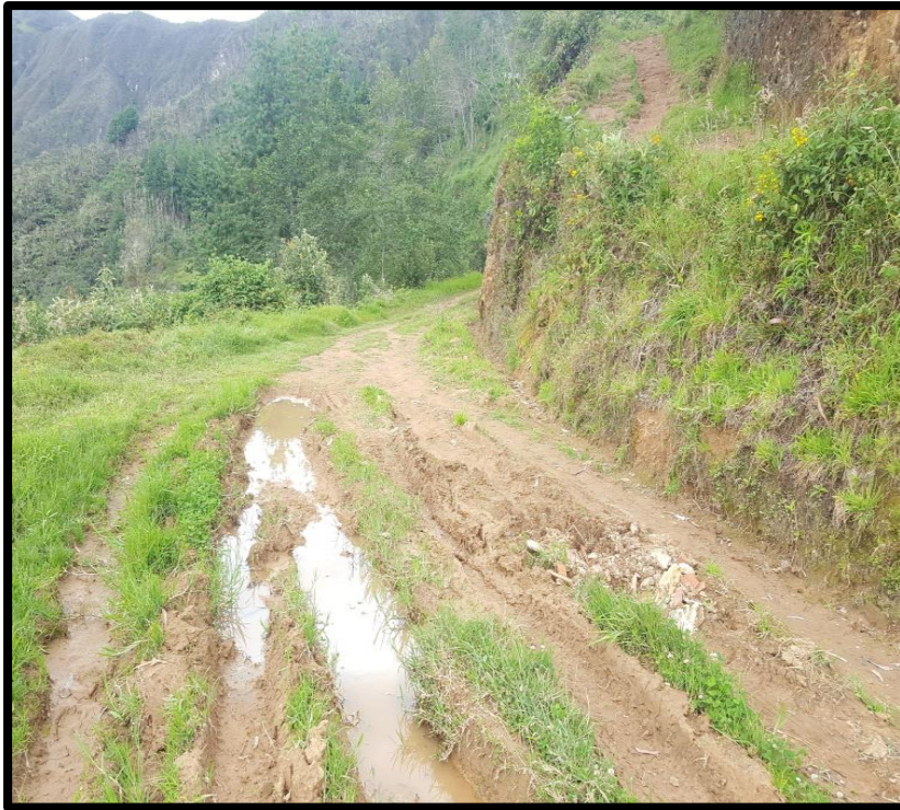
Imagen 3: mal estado de la vía, pérdida de geometría a lo largo de la vía
