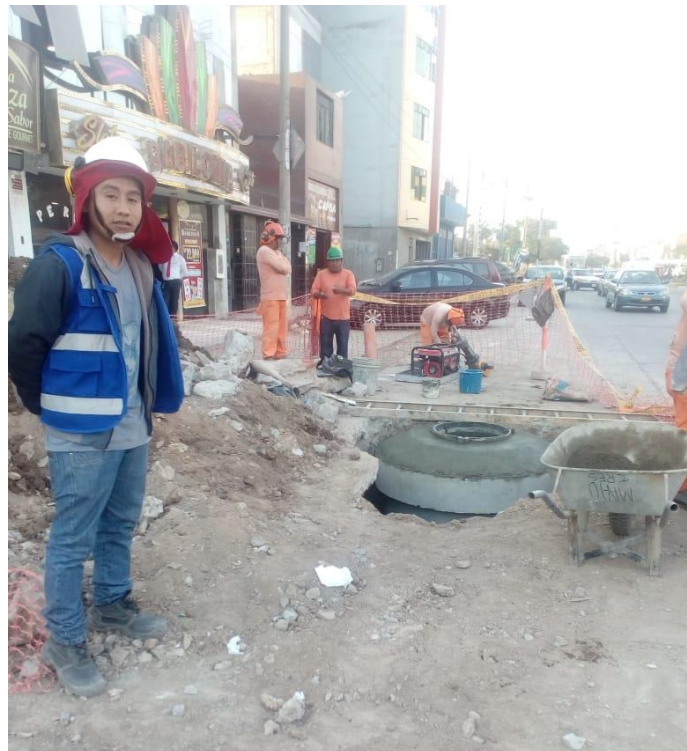
Figura 3-7. Zona de trabajo insegura
