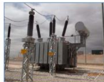
Transformador de potencia de 50 MVA
