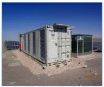
Caseta de Inversores y transformadores
