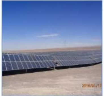
Vista de los paneles solares
