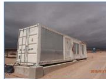
Cajeta de inversores
