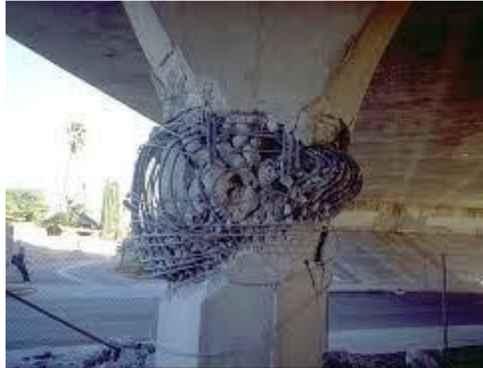
Figura 4. Falla de columna de concreto armado Fuente: Retrofitting Design of Building Structures, Xilin Lu (2010).
