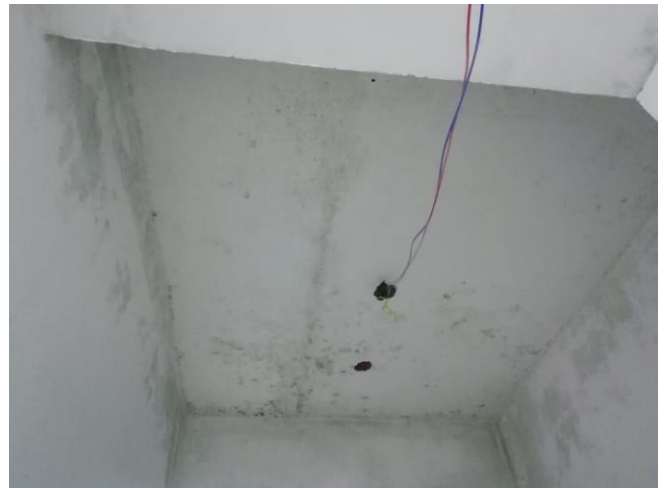
Presencia de hongos en cieloraso después de empaste.
