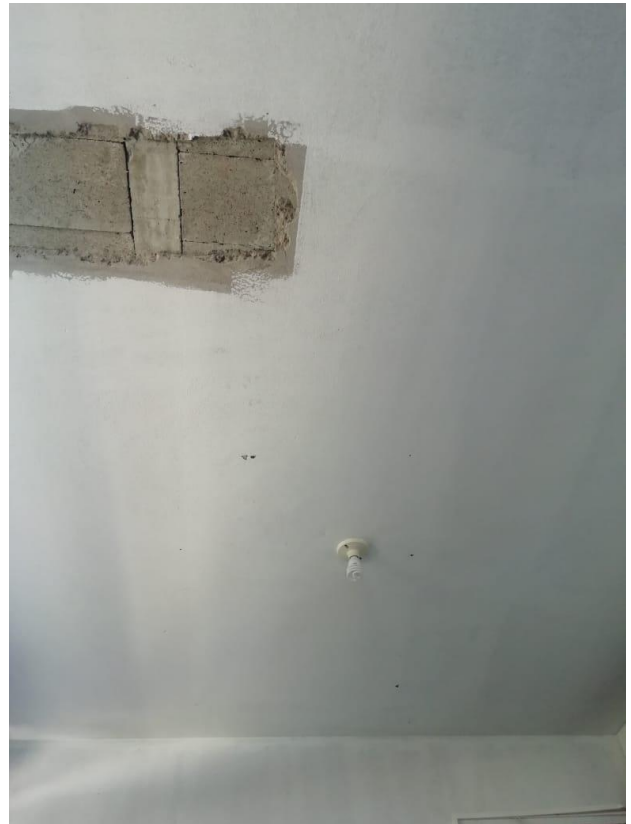
Desprendimiento después del tarrajeo – Losa Convencional
