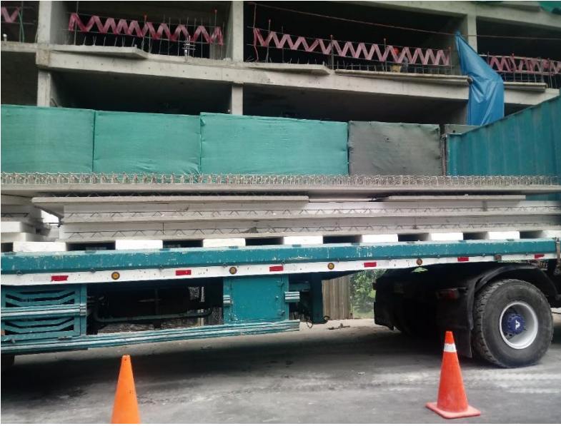
Camión de carga con las prelosas en las afueras del proyecto Park Tower
