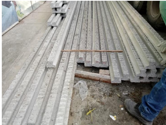
Figura 2. Viguetas Pretensadas Acopiadas fuera de área de obra. Fuente: Elaboración propia
