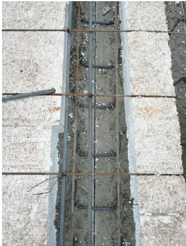
Desniveles en bordes de prelosas por 1 a 2mm.
