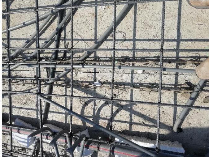
Figura 9. Unión de prelosas sin elemento de traslape entre ellos Fuente: Elaboración propia
