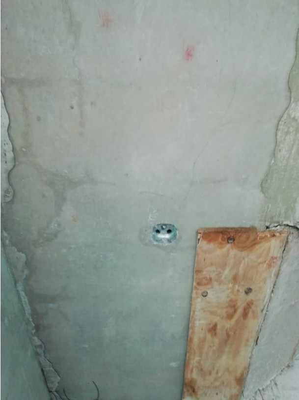
Rebabas y rebordes en esquinas en Losa Prefabricada.
