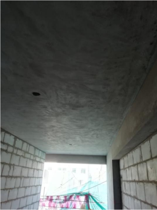
Tarrajeo de losa convencional sin presencia de tarrajeo.
