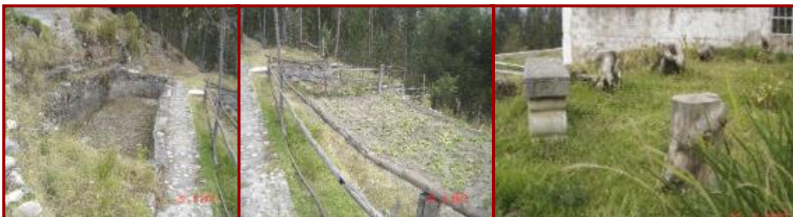
Colector de lluvia, para regadío
