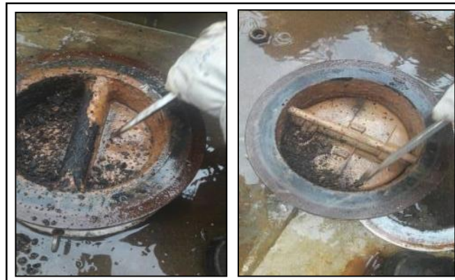
Ilustración 43. Válvula Check con óxido y barro endurecido
