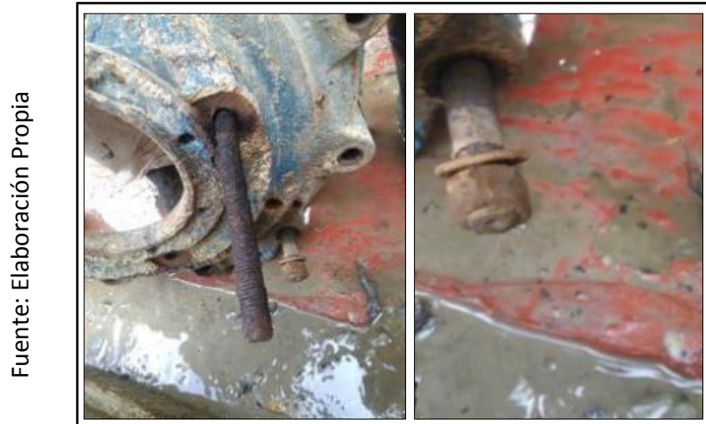
Ilustración 32. Modo de Falla - Pernos Corroidos
