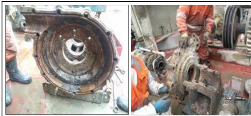
Ilustración 36. Carcasa y volutas corroídas
