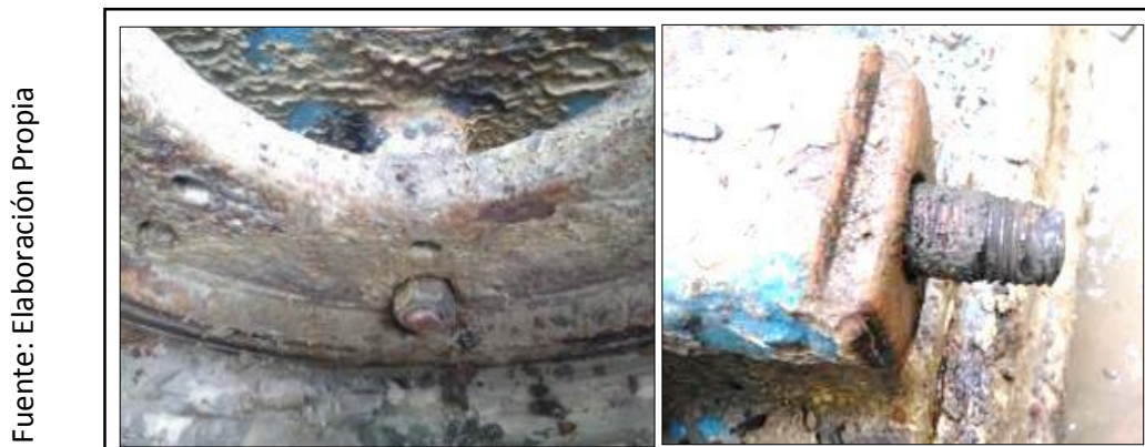
Ilustración 33. Corrosión en los metales
