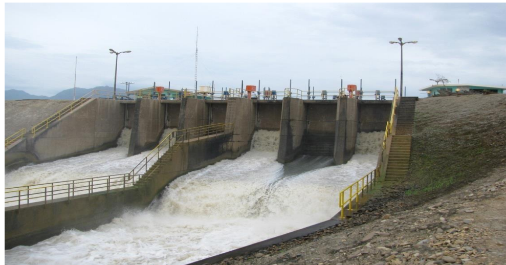
Figura 103. Compuertas de servicio.
