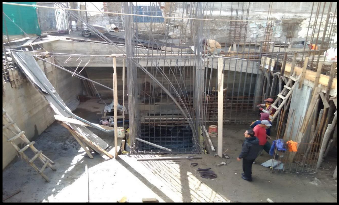
Figura 17. Acero del ascensor
