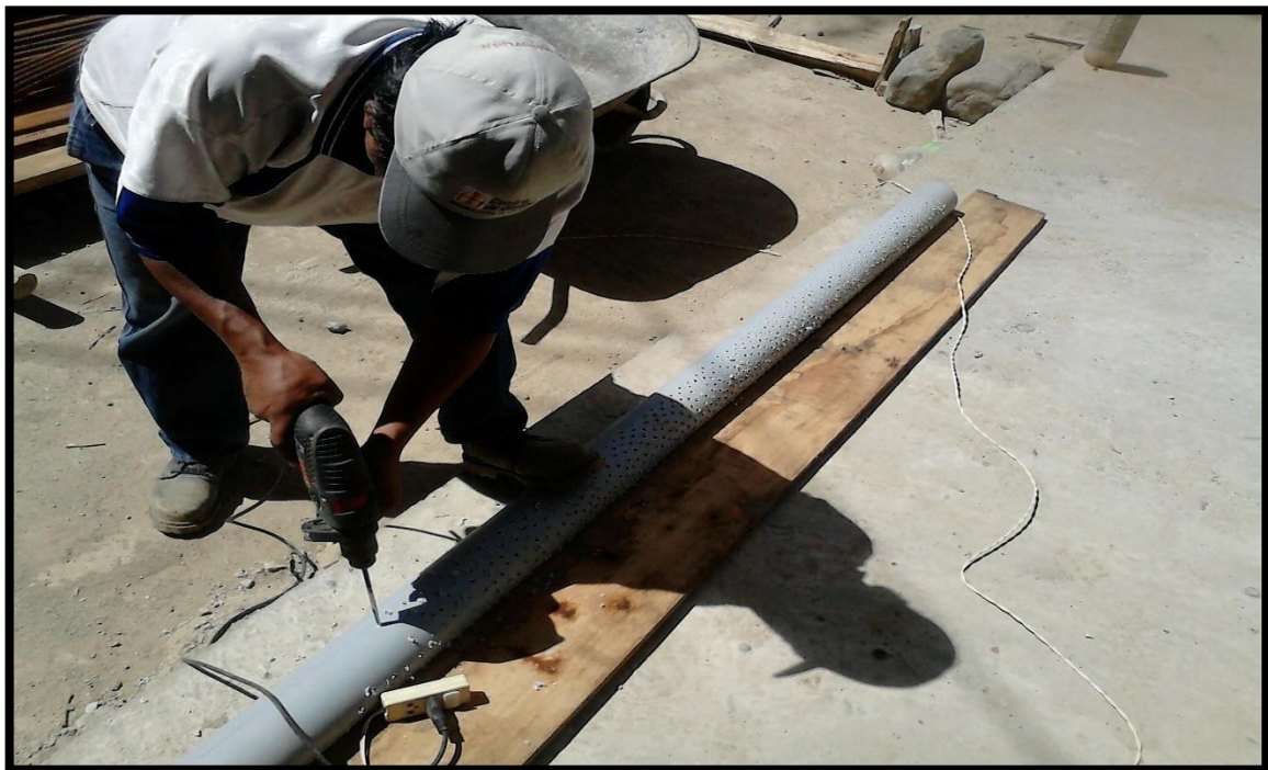
Figura 14. Preparando tubo de 5 “para canalizar el agua de la napa freática alta
