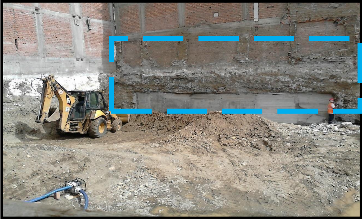
Figura 5. La edificación colindante solo tiene sótano en un 20 % y se tuvo que hacer calzaduras el 80 % de la edificación colindante.
