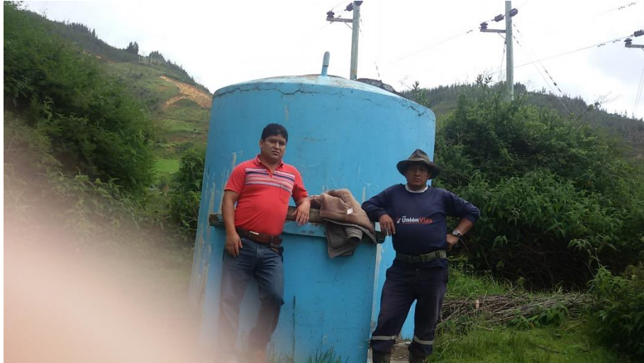
Figura 12. Vista de reservorio caserío Tambopampamarca, donde se aprecia el mal estado Fuente: Elaboración propia
