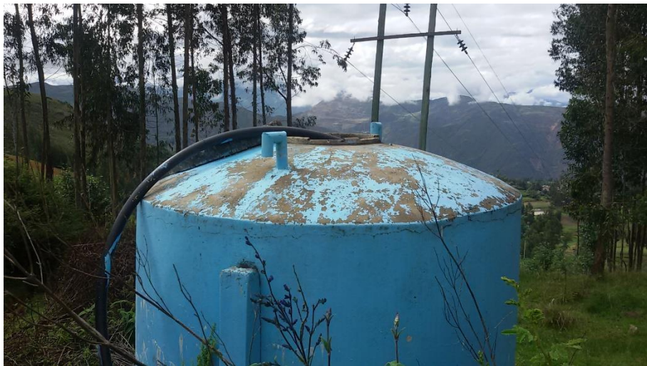
Figura 11. Vista de reservorio caserío Tambopampamarca, donde se aprecia el mal estado Fuente: Elaboración propia
