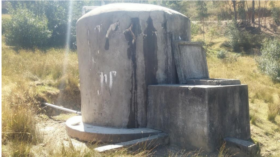
Figura 10. Vista de reservorio caserío Totorapampa, donde se aprecia el mal estado Fuente: Elaboración propia
