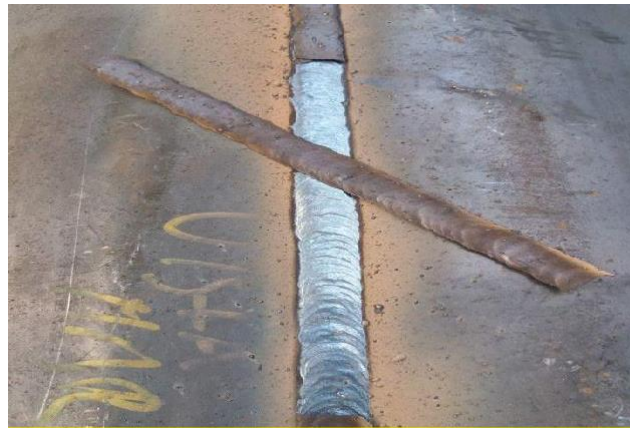
Figura 3 Depósito de Soldadura
