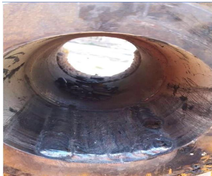
Relleno de alojamiento sobre material Fatigado
