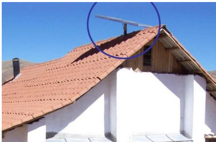
Figura 132. Sistema foto voltaico para energía eléctrica.
