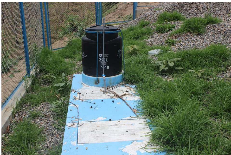
Figura 3: Contacto de cloro de la PTAR Amashca
