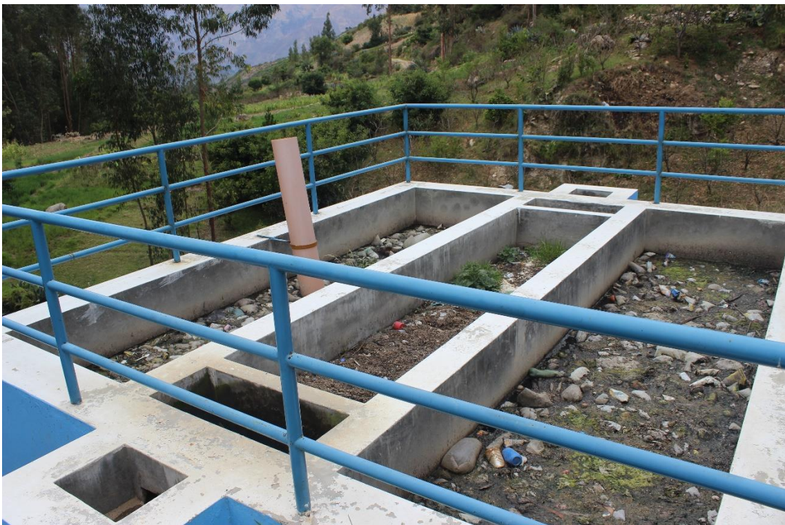
Figura 35 Vista delantera lateral del tanque IMHOFF de la Planta de tratamiento de aguas residuales
