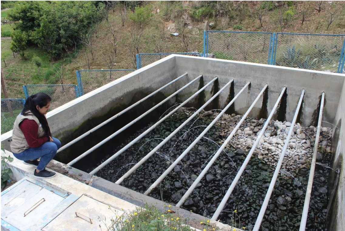
Figura 38 Vista superior lateral del filtro biológico de la Planta de tratamiento de aguas residuales
