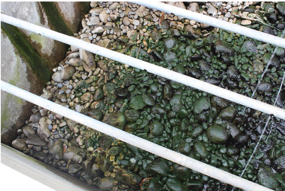
Figura 63 Patologías en la estructura del filtro biológico de la Planta de tratamiento de aguas residuales
