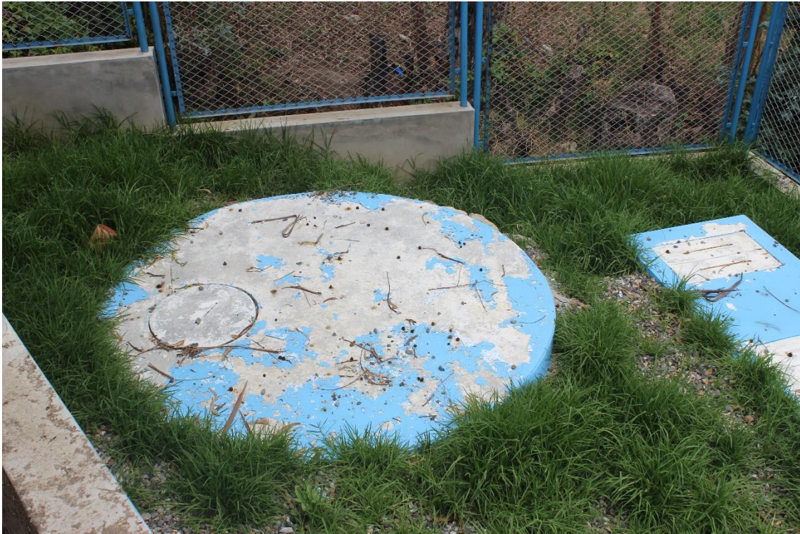
Figura 54 Patologías en el Contacto de Cloro de la Planta de tratamiento de aguas residuales
