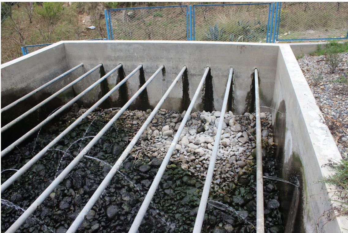
Figura 45 Vista panorámica del filtro biológico de la Planta de tratamiento de aguas residuales
