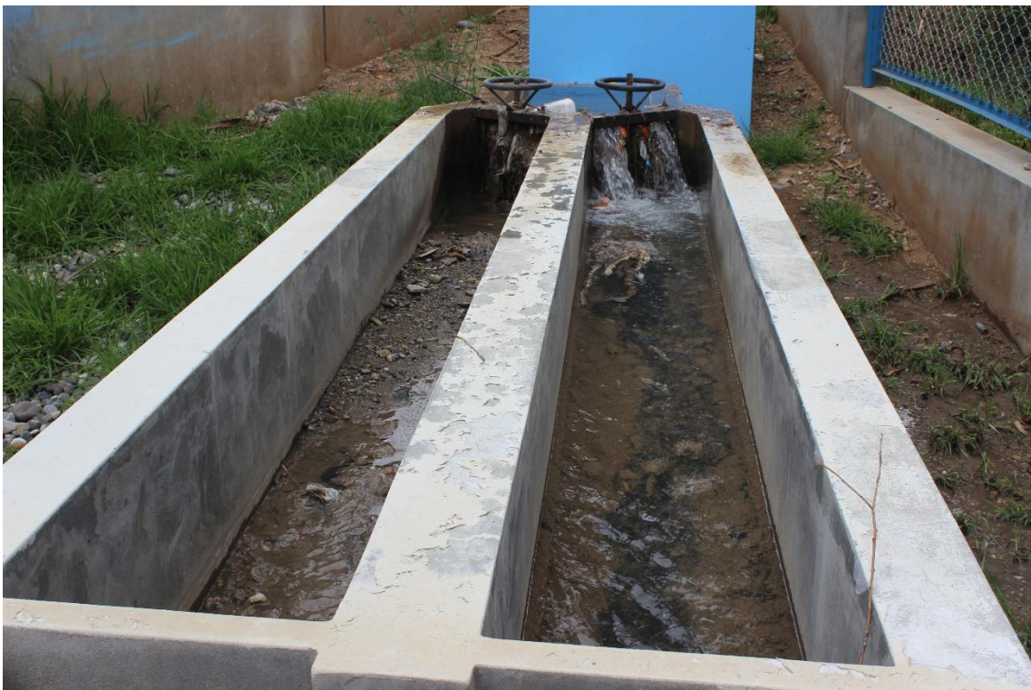
Figura 29 Vista superior frontal de la cámara de rejas de la Planta de tratamiento de aguas residuales
