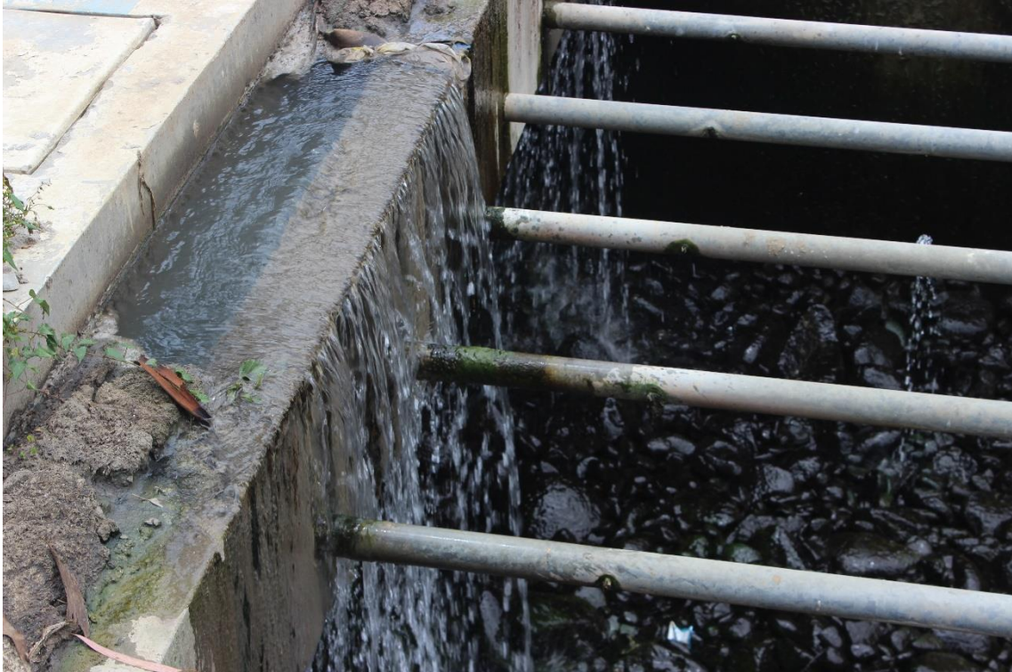
Figura 65 Patologías en la estructura del filtro biológico de la Planta de tratamiento de aguas residuales
