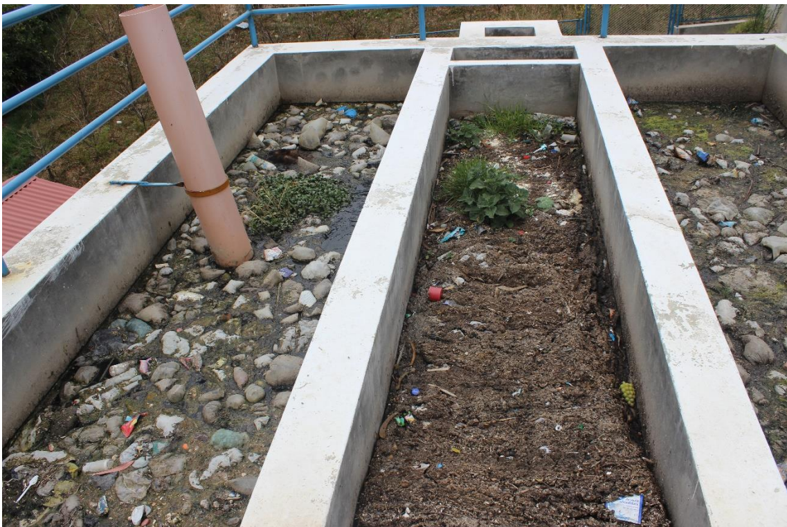
Figura 33 Vista delantera del tanque IMHOFF de la Planta de tratamiento de aguas residuales
