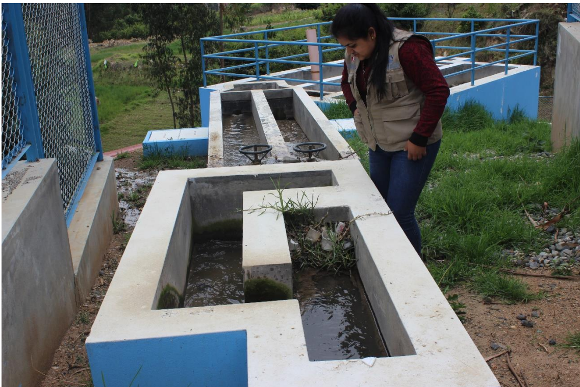
Figura 25 Vista superior de la cámara de rejas de la Planta de tratamiento de aguas residuales
