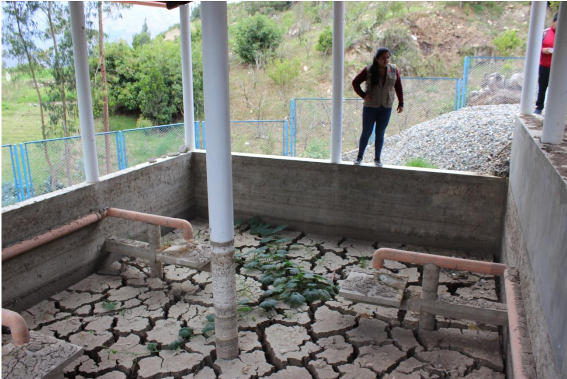
Figura 46 Lecho de secado de la Planta de tratamiento de aguas residuales
