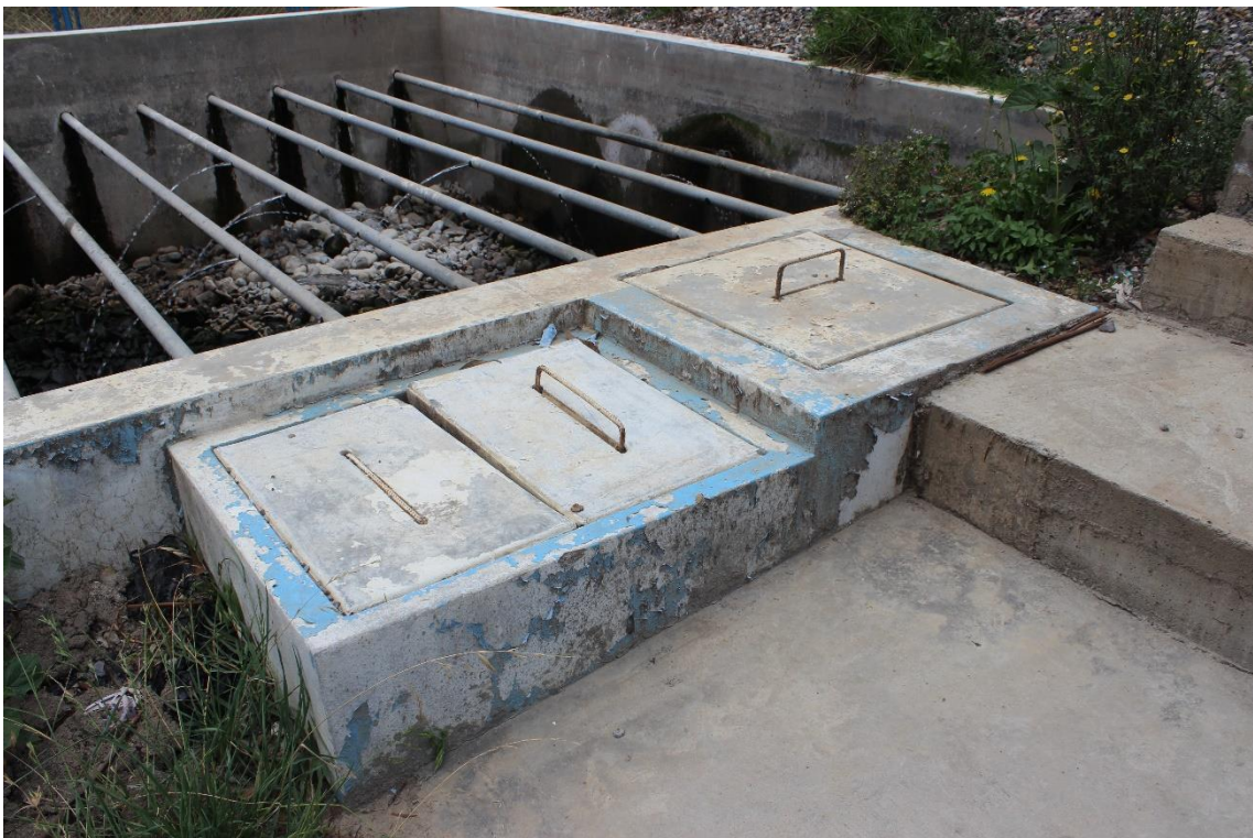
Figura 61 Patologías en la estructura del filtro biológico de la Planta de tratamiento de aguas residuales
