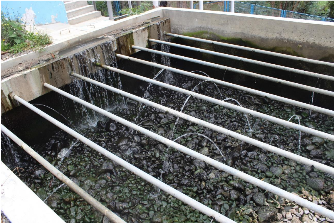
Figura 44 Vista de la base del filtro biológico de la Planta de tratamiento de aguas residuales
