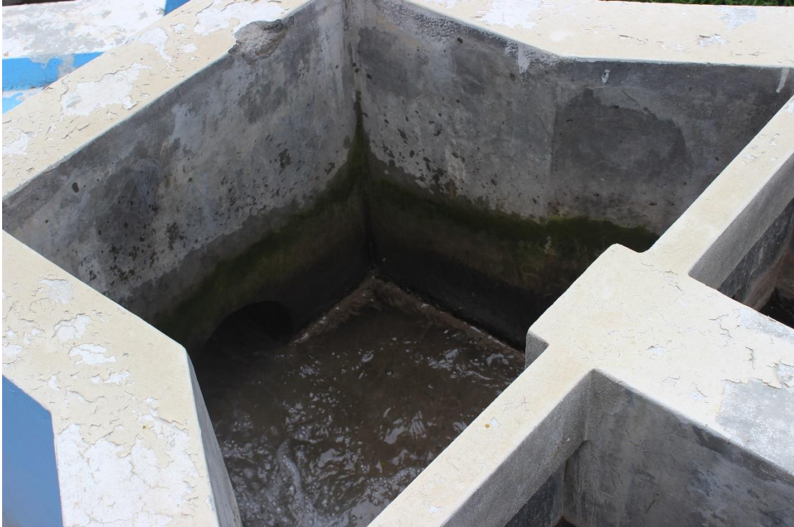
Figura 31 Vista de la evacuación de la cámara de rejas de la Planta de tratamiento de aguas residuales
