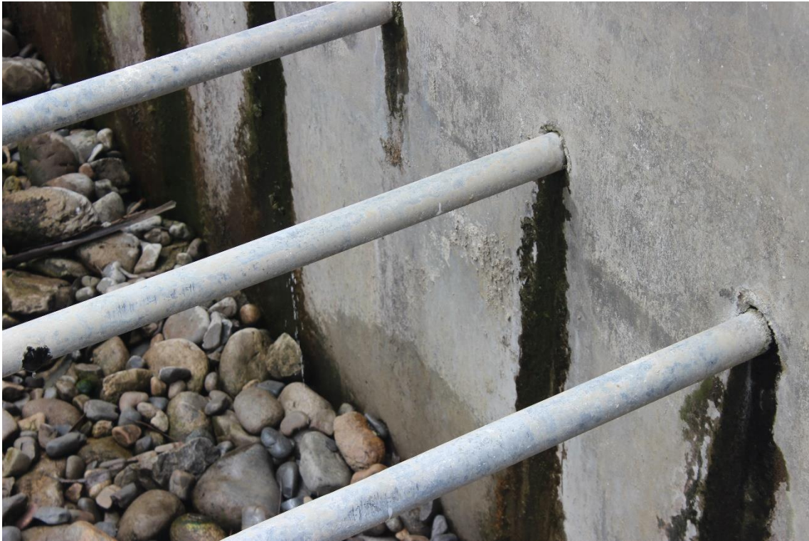
Figura 42 Condición de los tubos del filtro biológico de la Planta de tratamiento de aguas residuales
