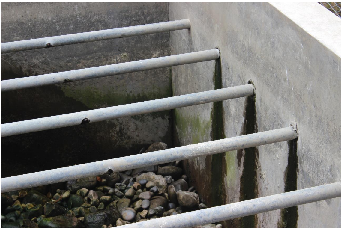
Figura 41 Condición de los tubos del filtro biológico de la Planta de tratamiento de aguas residuales
