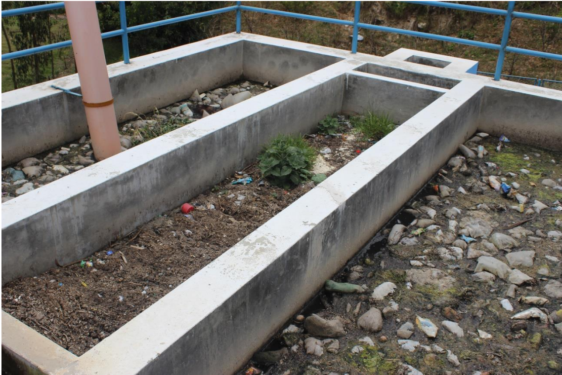
Figura 36 Vista lateral del tanque IMHOFF de la Planta de tratamiento de aguas residuales
