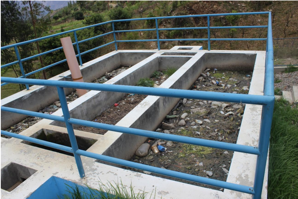
Figura 34 Vista delantera del tanque IMHOFF de la Planta de tratamiento de aguas residuales
