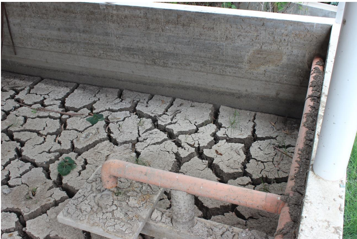
Figura 53 Patologías en el Lecho de Secado de la Planta de tratamiento de aguas residuales
