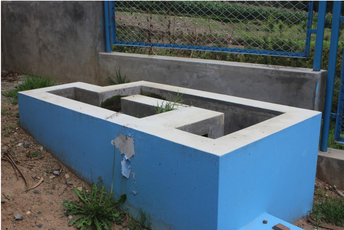
Figura 24 Vista lateral de la cámara de rejas de la Planta de tratamiento de aguas residuales
