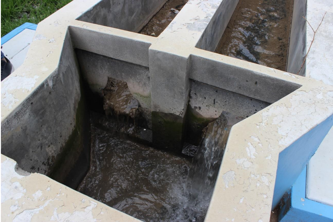
Figura 30 Vista delantera de la cámara de rejas de la Planta de tratamiento de aguas residuales
