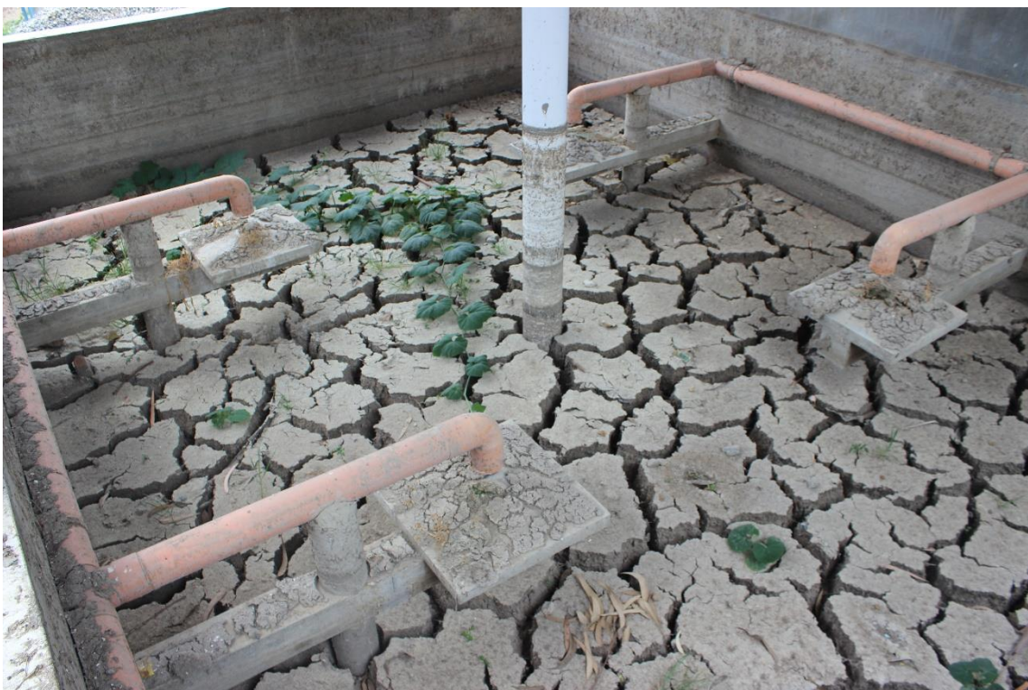
Figura 49 Patologías en el Lecho de Secado de la Planta de tratamiento de aguas residuales
