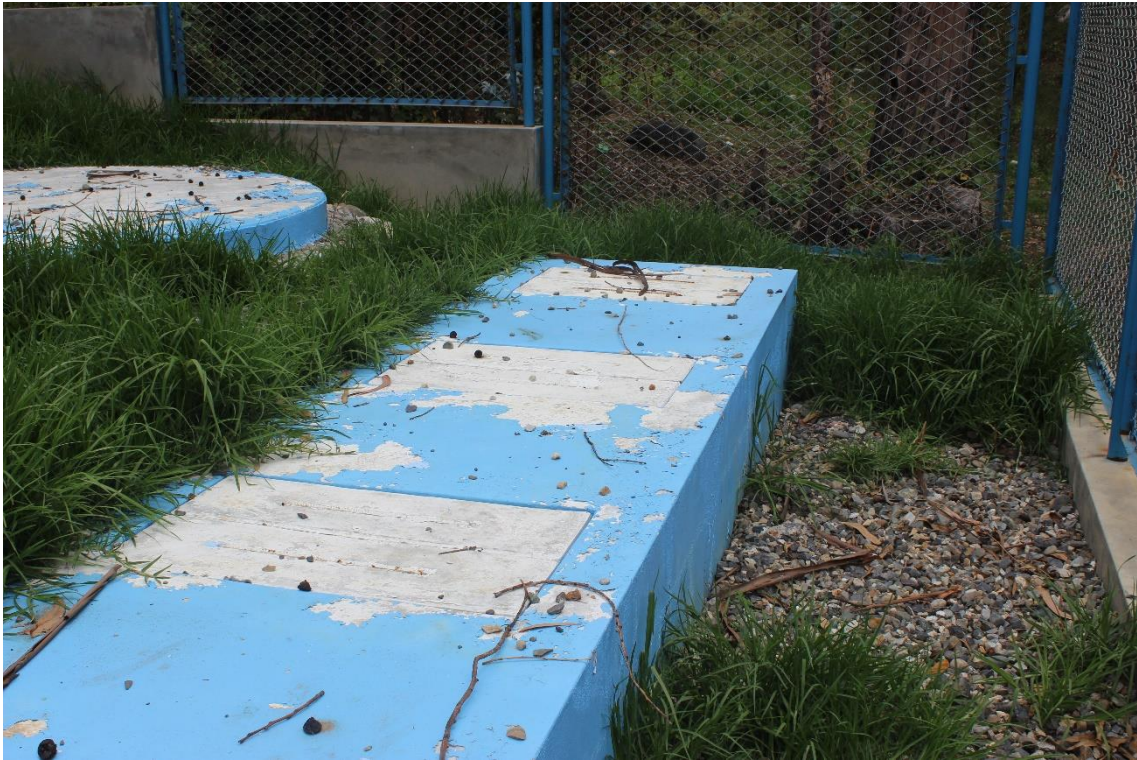
Figura 56 Patologías en el Contacto de Cloro de la Planta de tratamiento de aguas residuales
