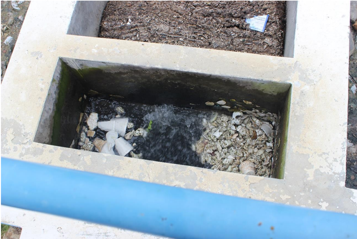
Figura 32 Evacuación final de la cámara de rejillas de la Planta de tratamiento de aguas residuales
