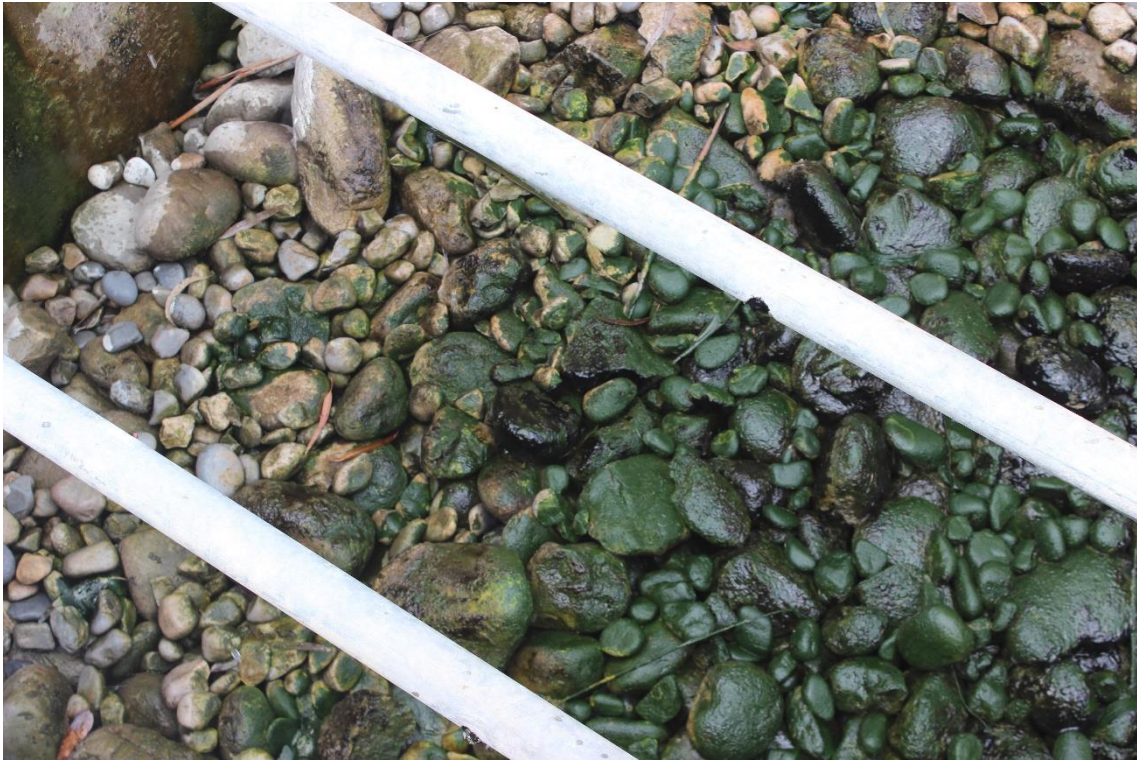
Figura 62 Patologías en la estructura del filtro biológico de la Planta de tratamiento de aguas residuales
