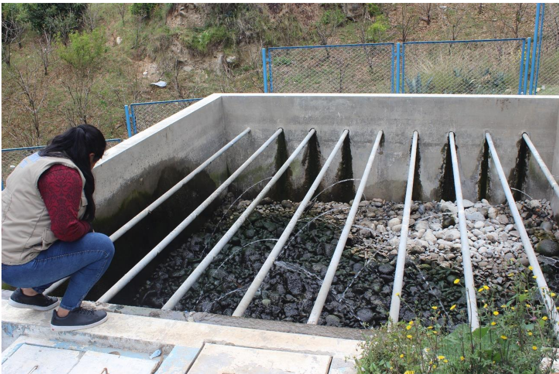
Figura 37 Vista lateral del filtro biológico de la Planta de tratamiento de aguas residuales
