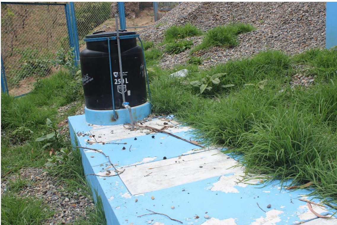
Figura 57 Patologías en el Contacto de Cloro de la Planta de tratamiento de aguas residuales
