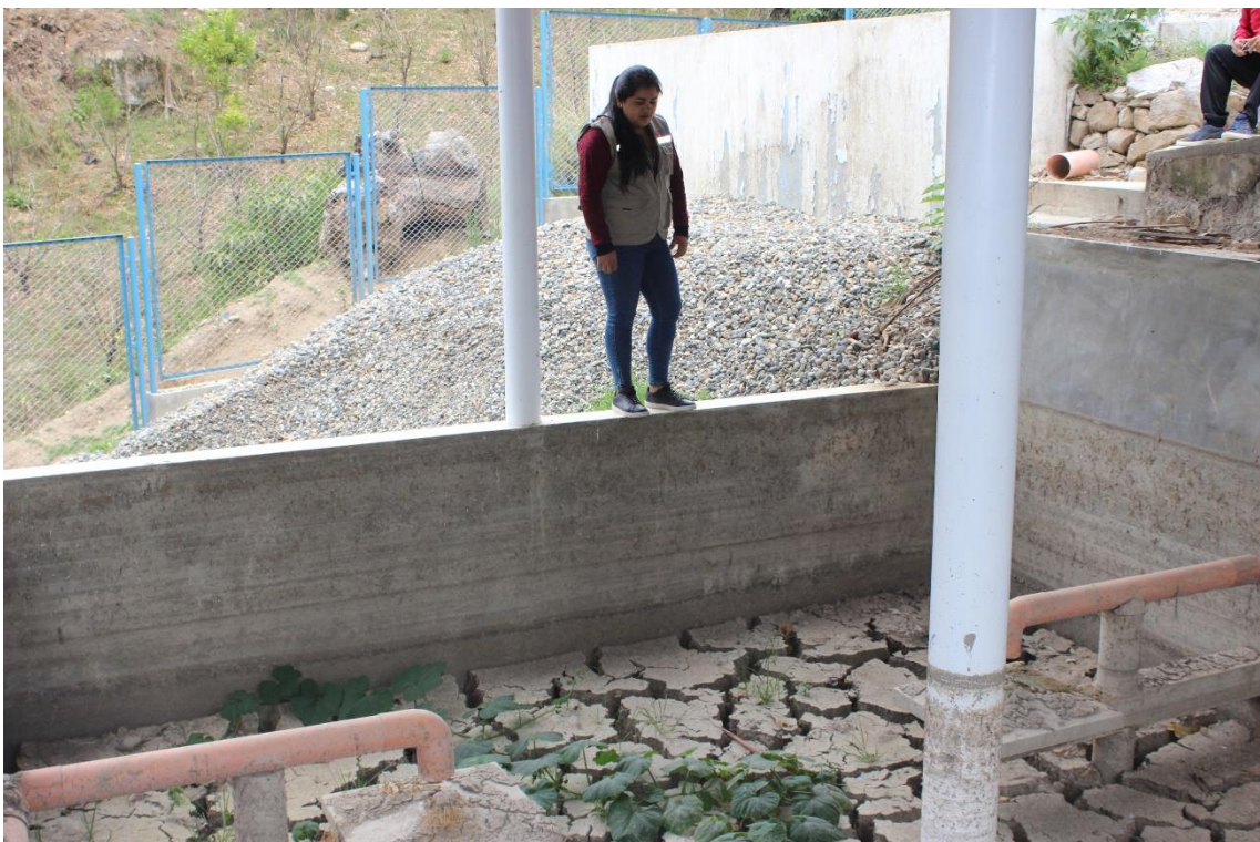
Figura 47 Lecho de secado de la Planta de tratamiento de aguas residuales
