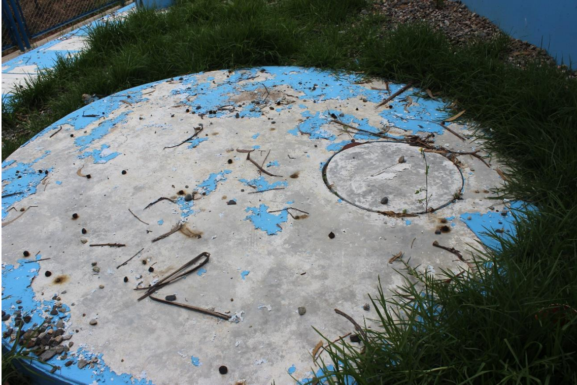
Figura 58 Patologías en el Contacto de Cloro de la Planta de tratamiento de aguas residuales
