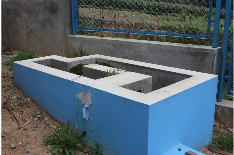
Figura 2: Cámara de Rejas de la PTAR Amashca
