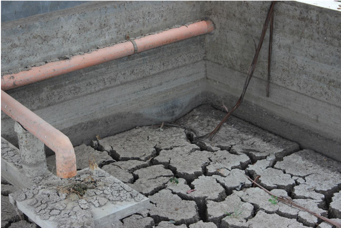
Figura 52 Patologías en el Lecho de Secado de la Planta de tratamiento de aguas residuales
