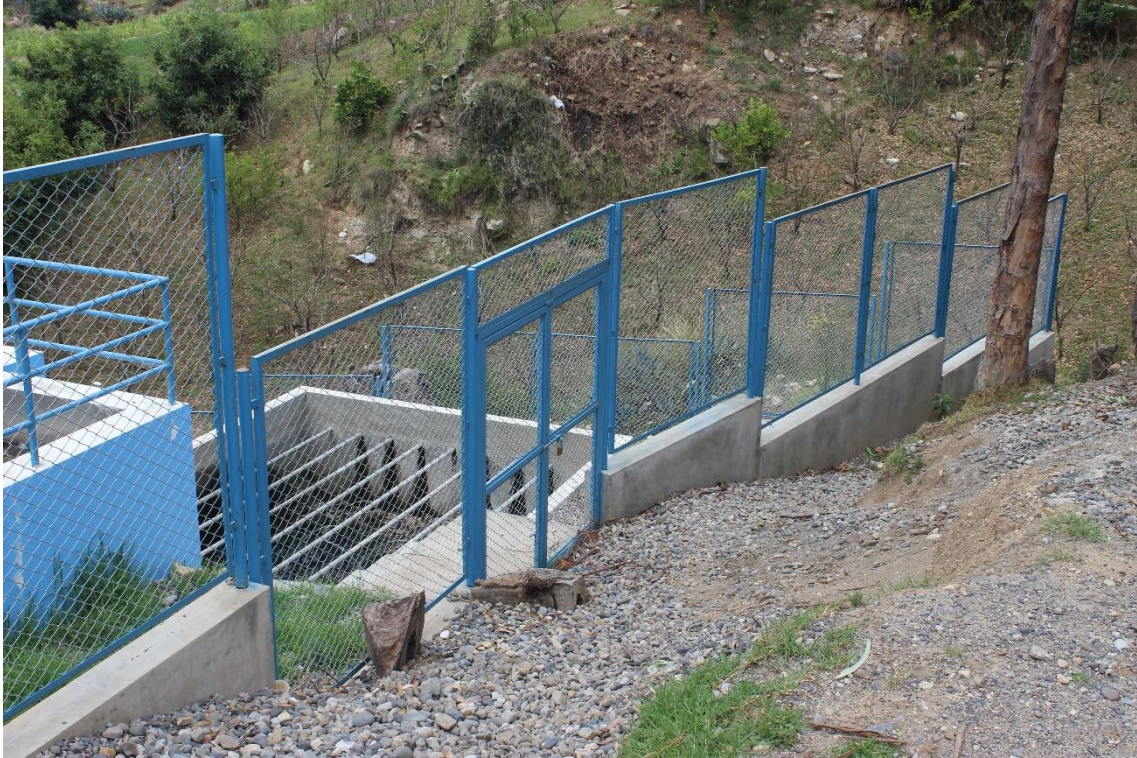
Figura 20 Vista externa de la Planta de tratamiento de aguas residuales
