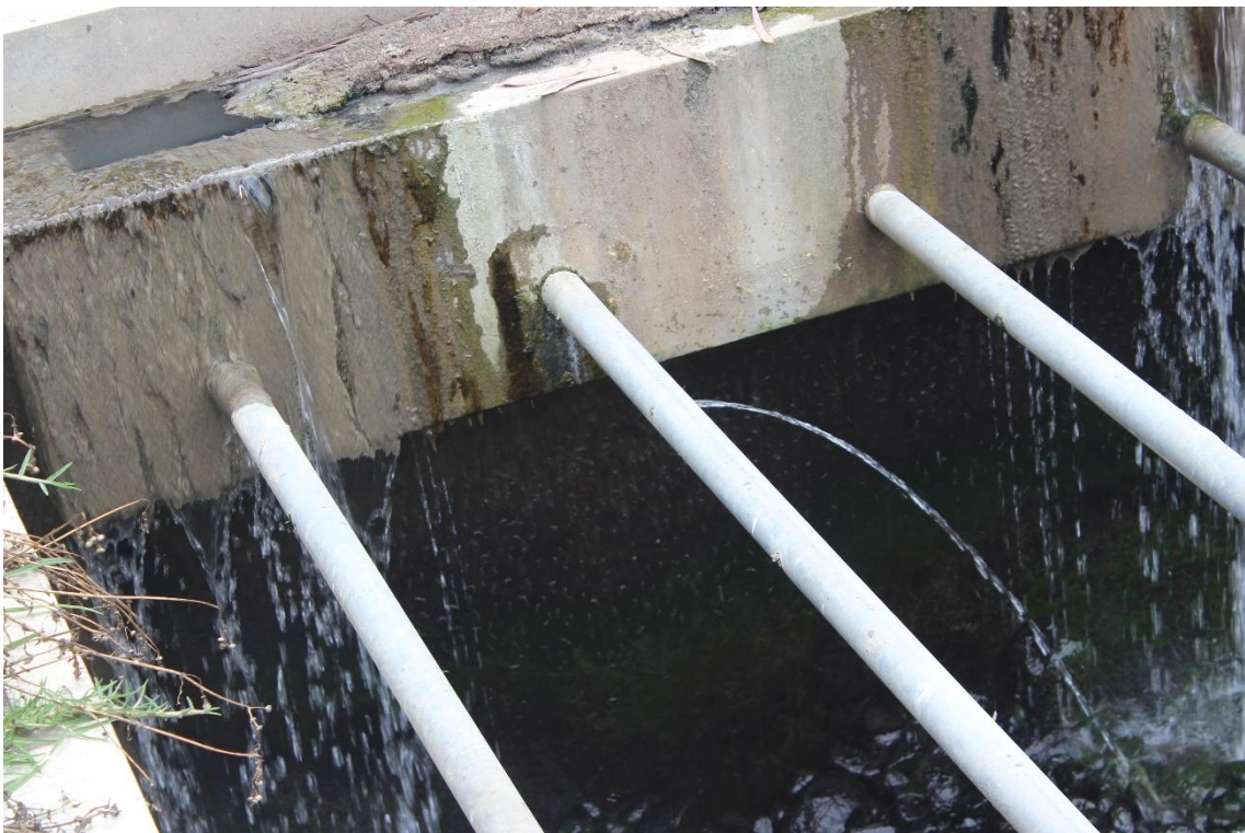
Figura 43 Patologías en el filtro biológico de la Planta de tratamiento de aguas residuales
