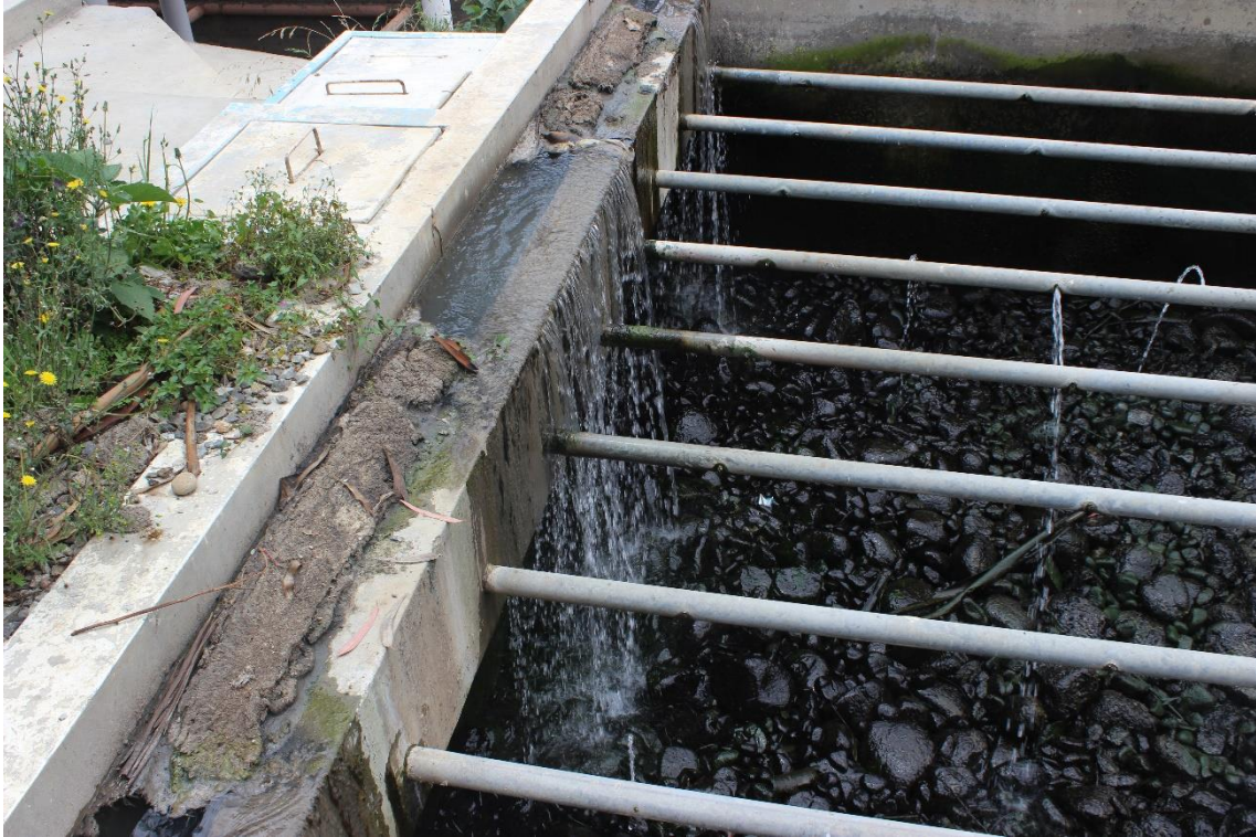
Figura 64 Patologías en la estructura del filtro biológico de la Planta de tratamiento de aguas residuales
