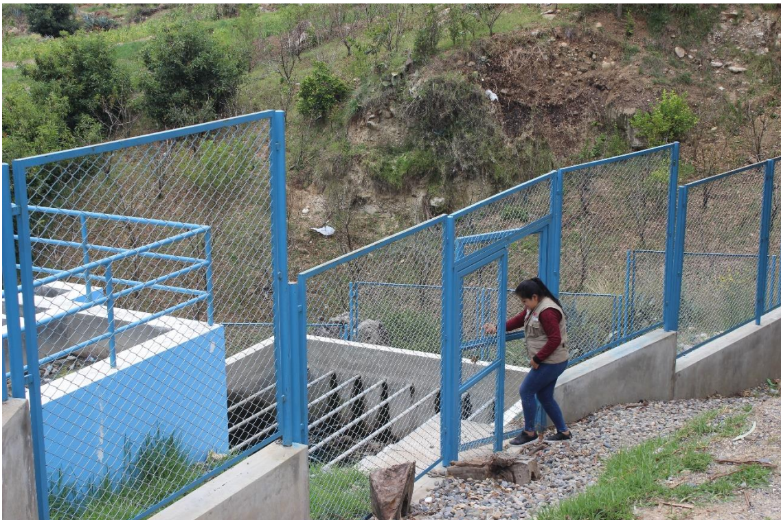
Figura 23 Ingreso a la Planta de tratamiento de aguas residuales
