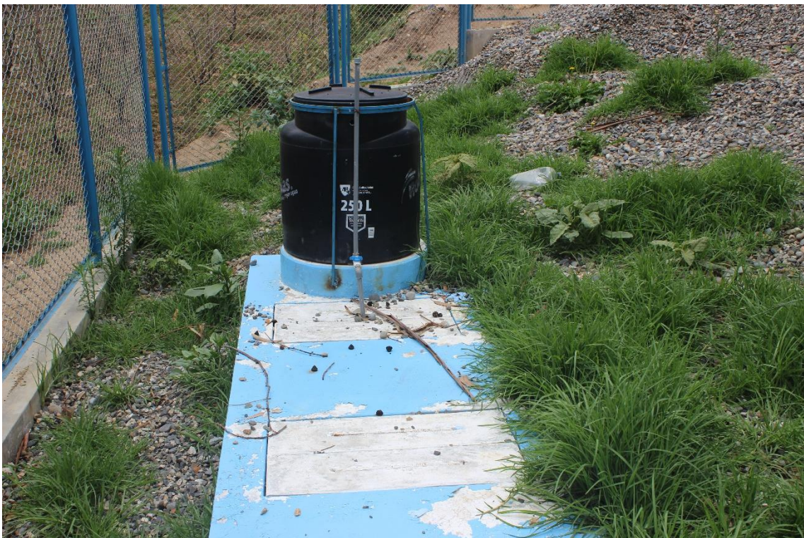
Figura 55 Patologías en el Contacto de Cloro de la Planta de tratamiento de aguas residuales
