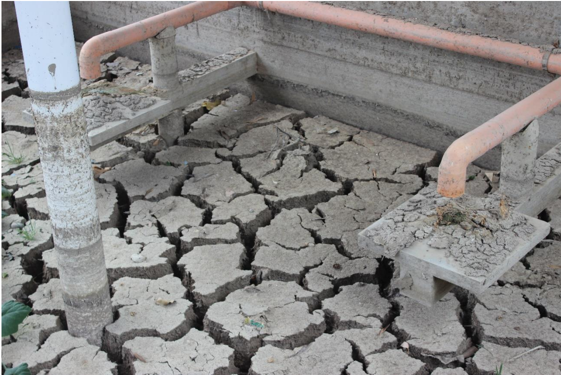
Figura 50 Patologías en el Lecho de Secado de la Planta de tratamiento de aguas residuales
