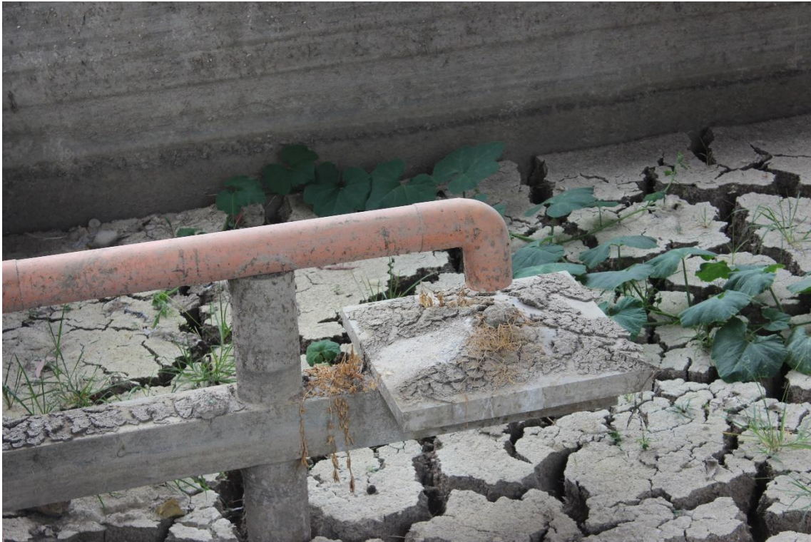
Figura 48 Patologías en el Lecho de Secado de la Planta de tratamiento de aguas residuales
