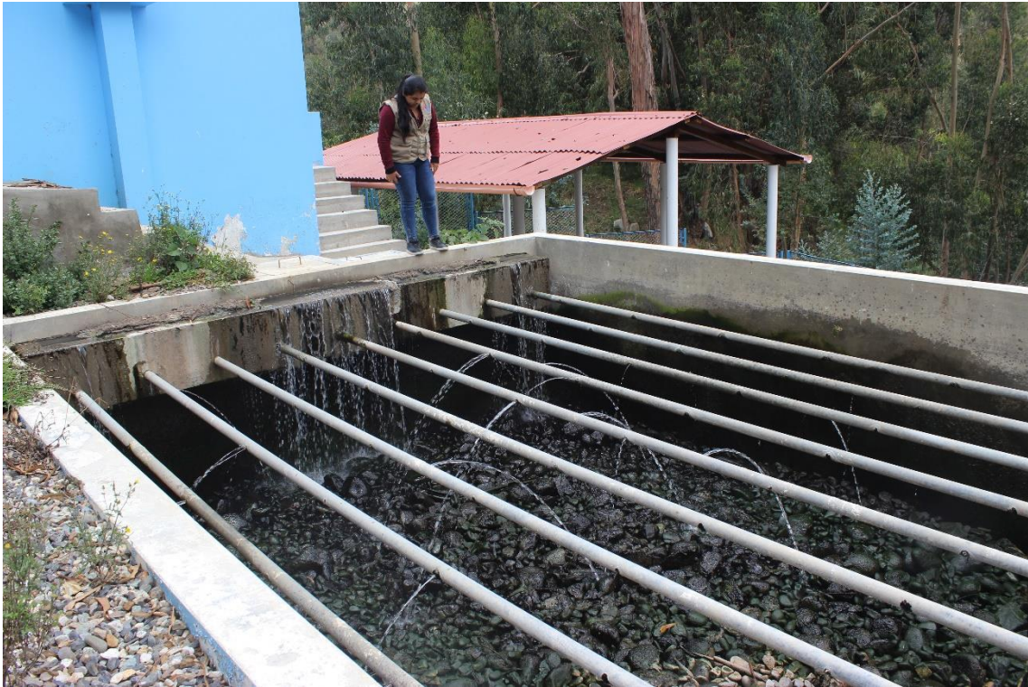
Figura 40 Vista delantero lateral del filtro biológico de la Planta de tratamiento de aguas residuales
