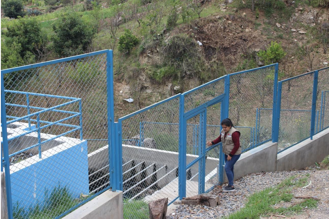
Figura 22 Apertura de la Planta de tratamiento de aguas residuales
