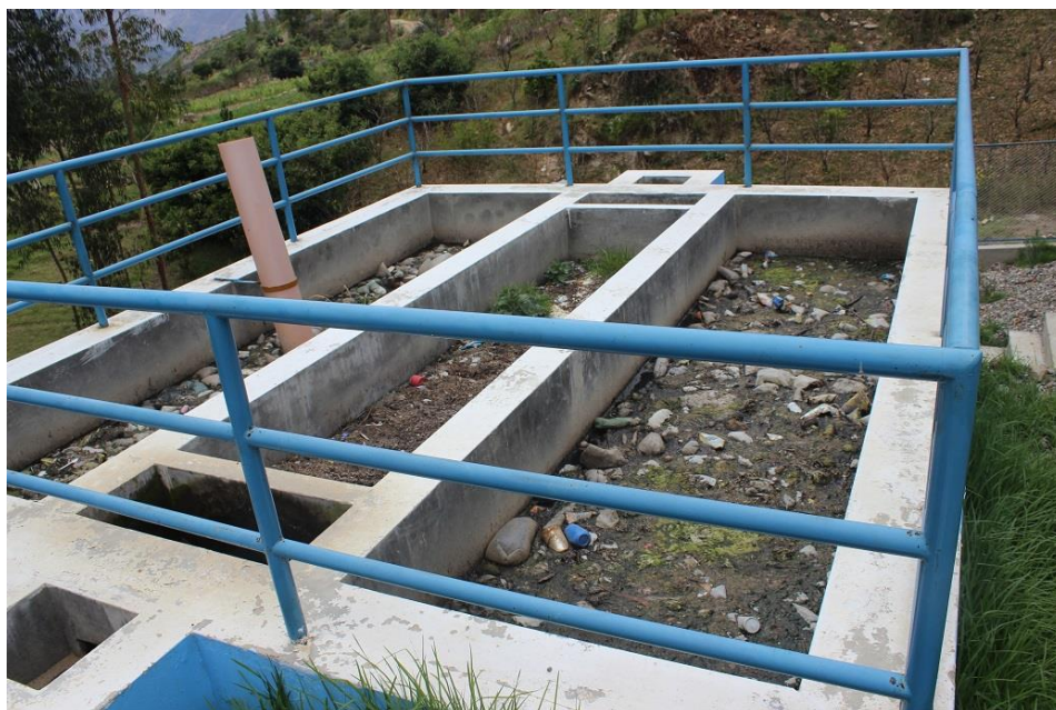
Figura 1: Tanque IMHOFF de la PTAR Amashca
