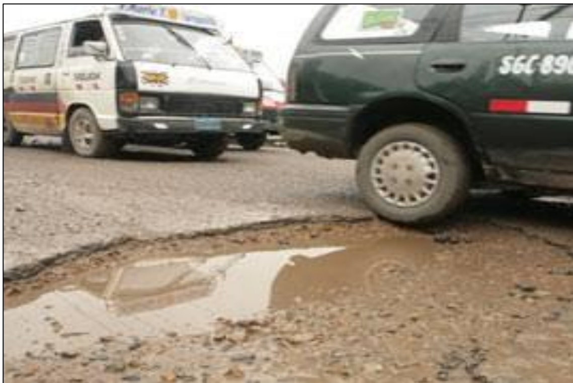
Figura 01: Zona afectada en Avenida Malecón Checa.
