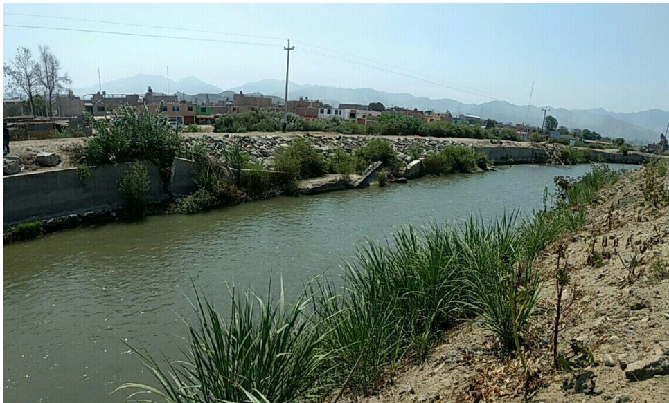
Fotografía del muro de contención afectada por el Fenómeno del Niño ocurrido en el año 2017.
