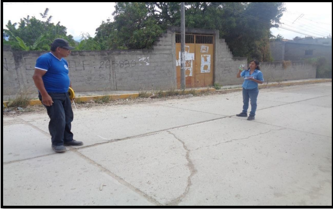
FOTO N° 01: Observación de las grietas de esquina y lineales.
