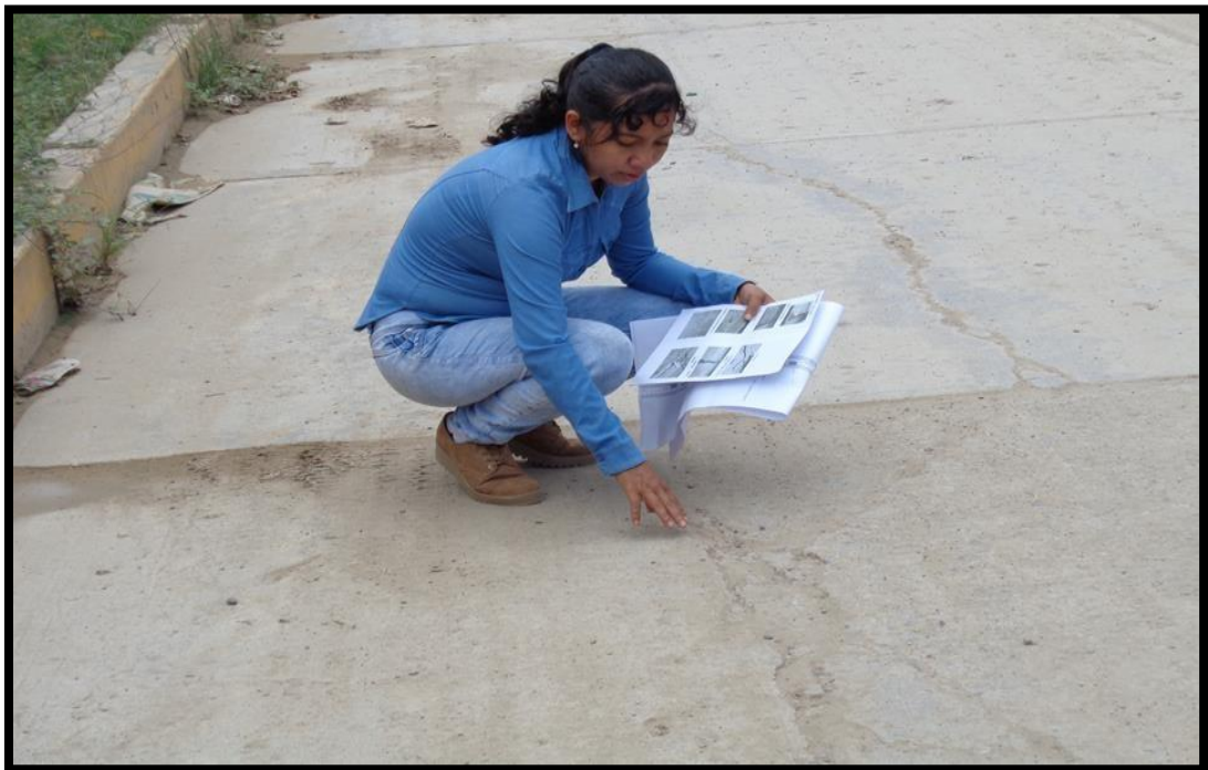
FOTO N° 08: Revisando grietas en las cuadras.
