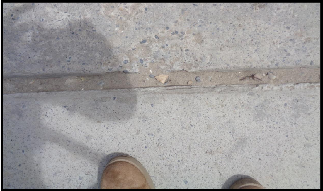
FOTO N° 09: Observando daños de las juntas.
