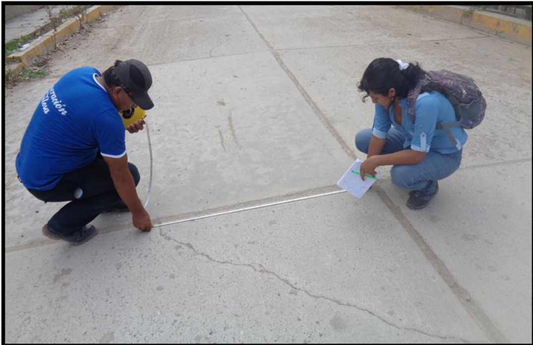
FOTO N° 02: Medición de grietas de esquina.
