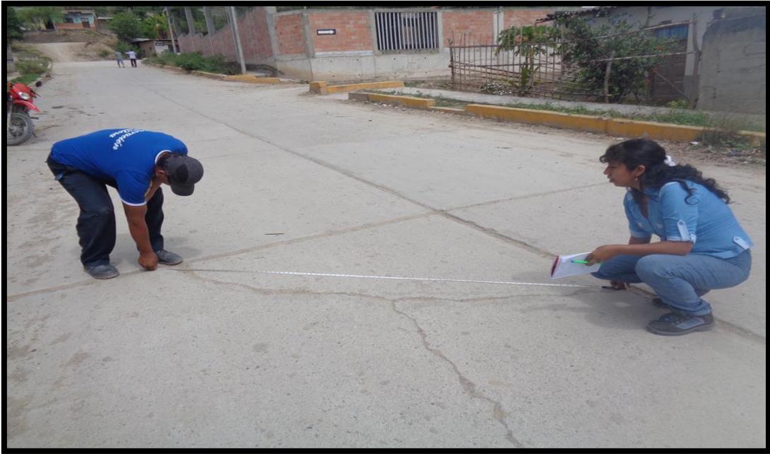
FOTO N° 03: Medicion de las grietas de esquina.
