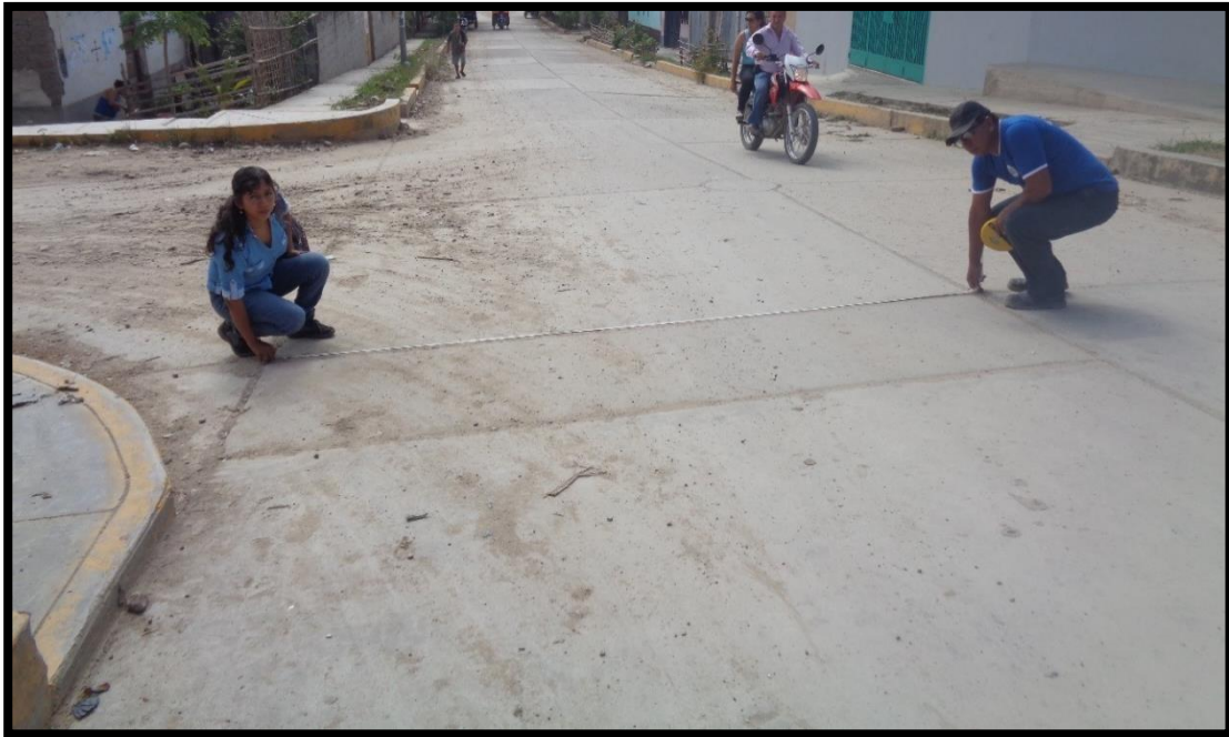
FOTO N° 05: Medición de los parches grandes.
