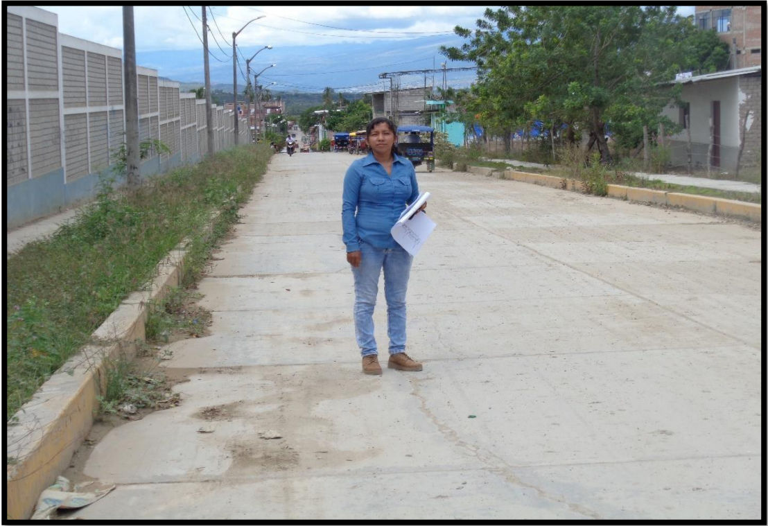
FOTO N° 07: Observando las grietas lineales.
