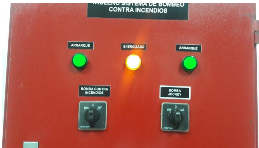
Figura 19 Tablero Automatizado de Cisterna Contra Incendio
