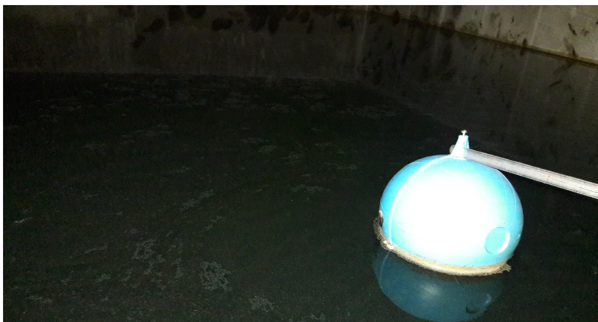
Figura 18 Cisterna Contra Incendio
