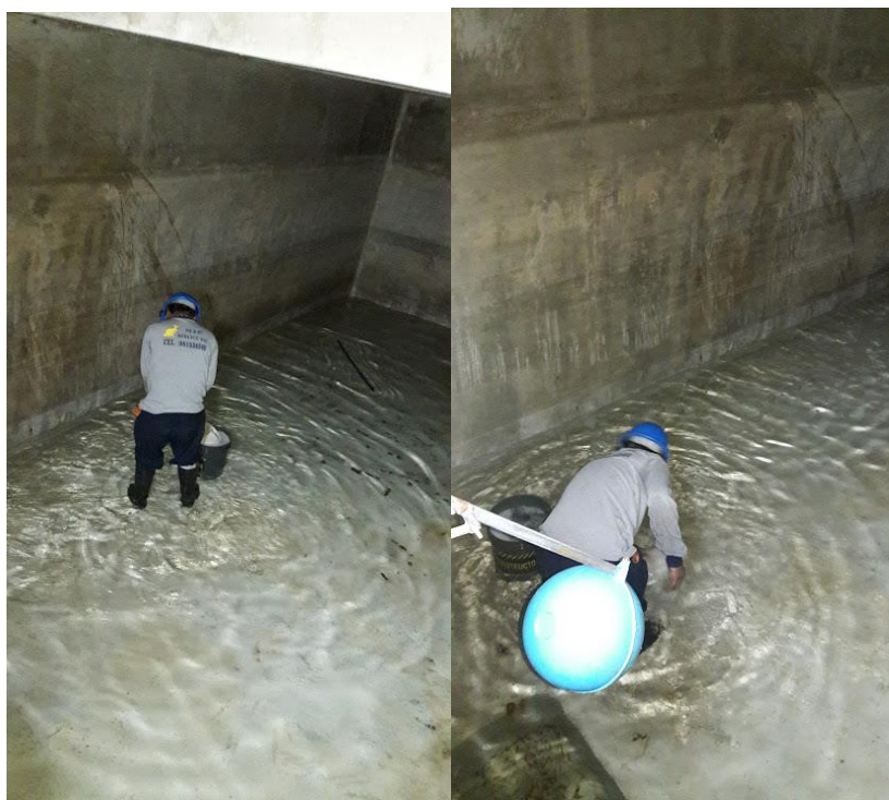
Figura 104. Enjuague de cisterna contra incendio
