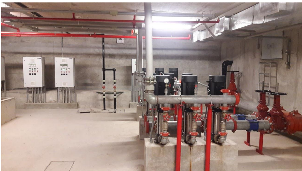
Figura 17 Área de Cuarto de Bomba
