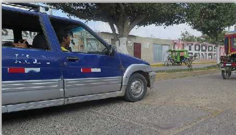
Figura 3. Pistas de Tumbes en mal estado. Fuente: Diario El Correo 2016.
