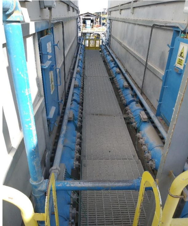
Figura 1. Válvulas Pulso Jet Fuente: Elaboración propia
