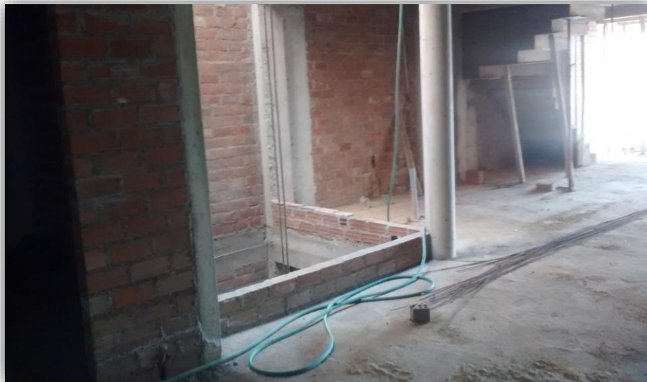
FIGURA 20: LOS TRAGALUCES NO CUENTAN CON CINTA DE SEGURIDAD, NO HAY PROTECCIÓN PARA EL ACERO TIRADO POR EL PISO, IGUAL CON LA MANGUERA DE AGUA.
