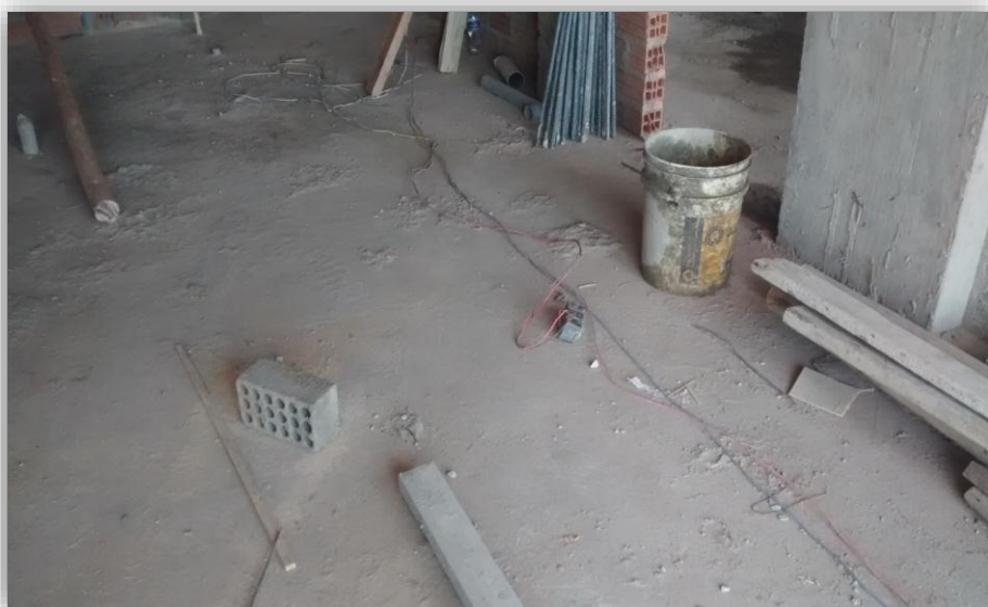
FIGURA 18: FALTA ORDEN Y LIMPIEZA, CABLEADO ELÉCTRICO POR EL PISO SIN PROTECCIÓN
