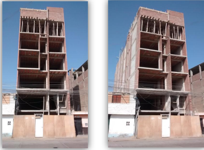
FIGURA 11: VISTA FRONTAL EXTERIOR DEL EDIFICIO MULTIFAMILIAR AV. JORGE CHÁVEZ-CHICLAYO. FALTA DE CINTA O MALLA DE SEGURIDAD.
