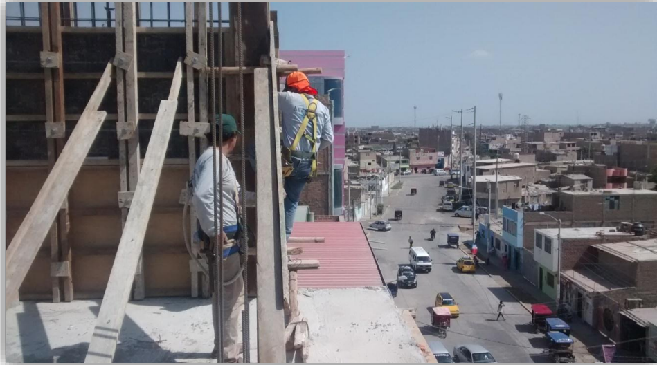
FIGURA 15: FALTA DE MALLA DE SEGURIDAD 6TO. PISO
