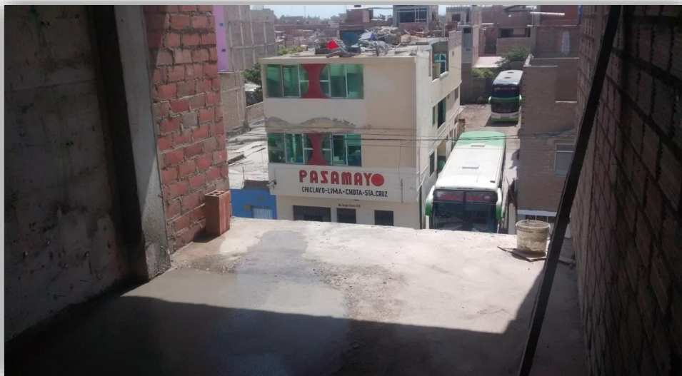
FIGURA 16: NO SE CUENTA DE CINTA DE PELIGRO O MALLA DE SEGURIDAD 3ER. PISO
