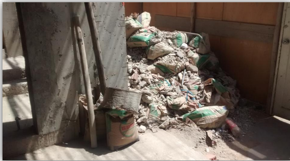
FIGURA 22: FALTA ORDEN Y LIMPIEZA PARA LOS DESMONTES O DESPERDICIOS
