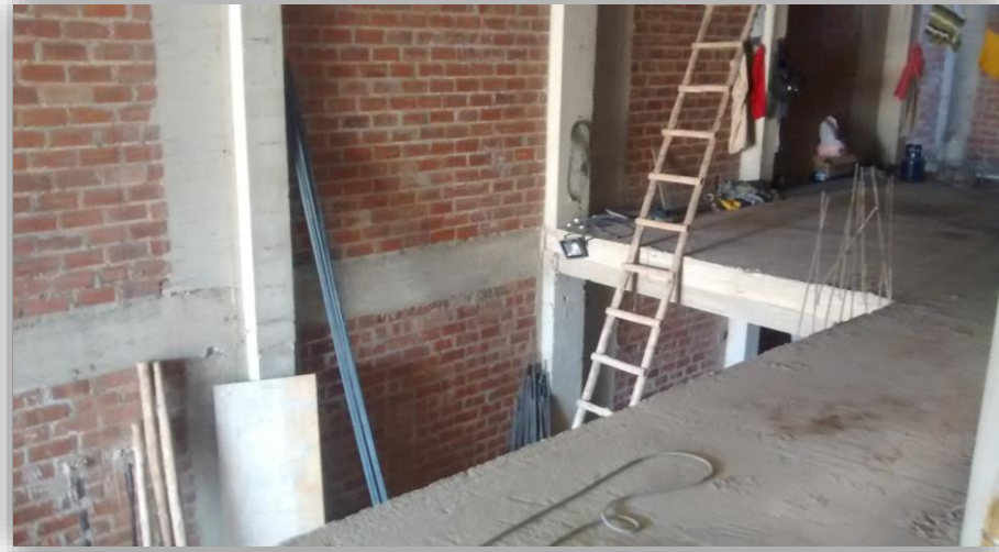
FIGURA 21: LA PARTE DEL MEZANINE NO ESTÁ PROTEGIDA, LO CUAL ES PELIGRO INMINENTE PARA LOS TRABAJADORES
