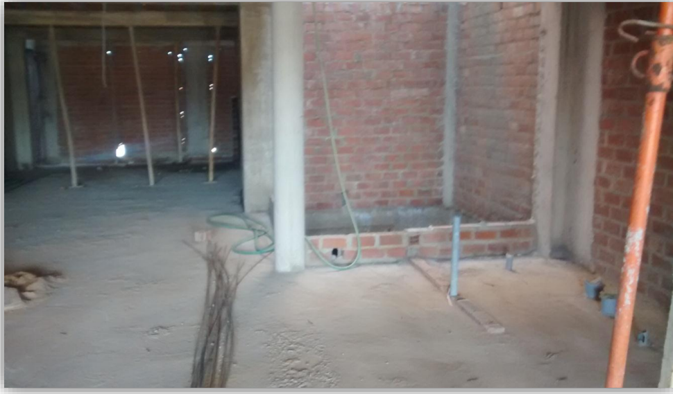
FIGURA 19: LOS TRAGALUCES NO CUENTAN CON CINTA DE SEGURIDAD
