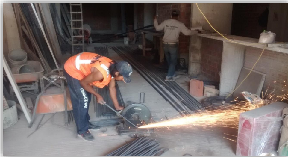
FIGURA 12: FALTA ORDEN Y LIMPIEZA, EL PERSONAL NO CUENTA CON EPI (EQUIPO DE PROTECCIÓN INDIVIDUAL): GUANTES, LENTES Y TAPONES DE OÍDOS.
