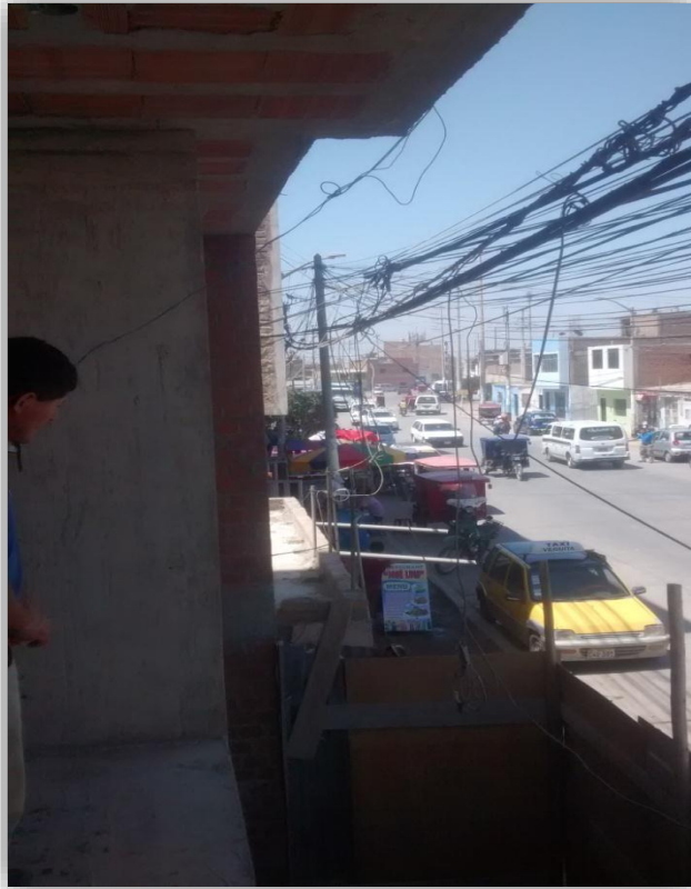
FIGURA 23: PELIGRO INMINENTE, LOS CABLES DE BT (BAJA TENSIÓN) ESTÁN ROSANDO LA FACHADA DEL EDIFICIO AV. JORGE CHÁVEZ
