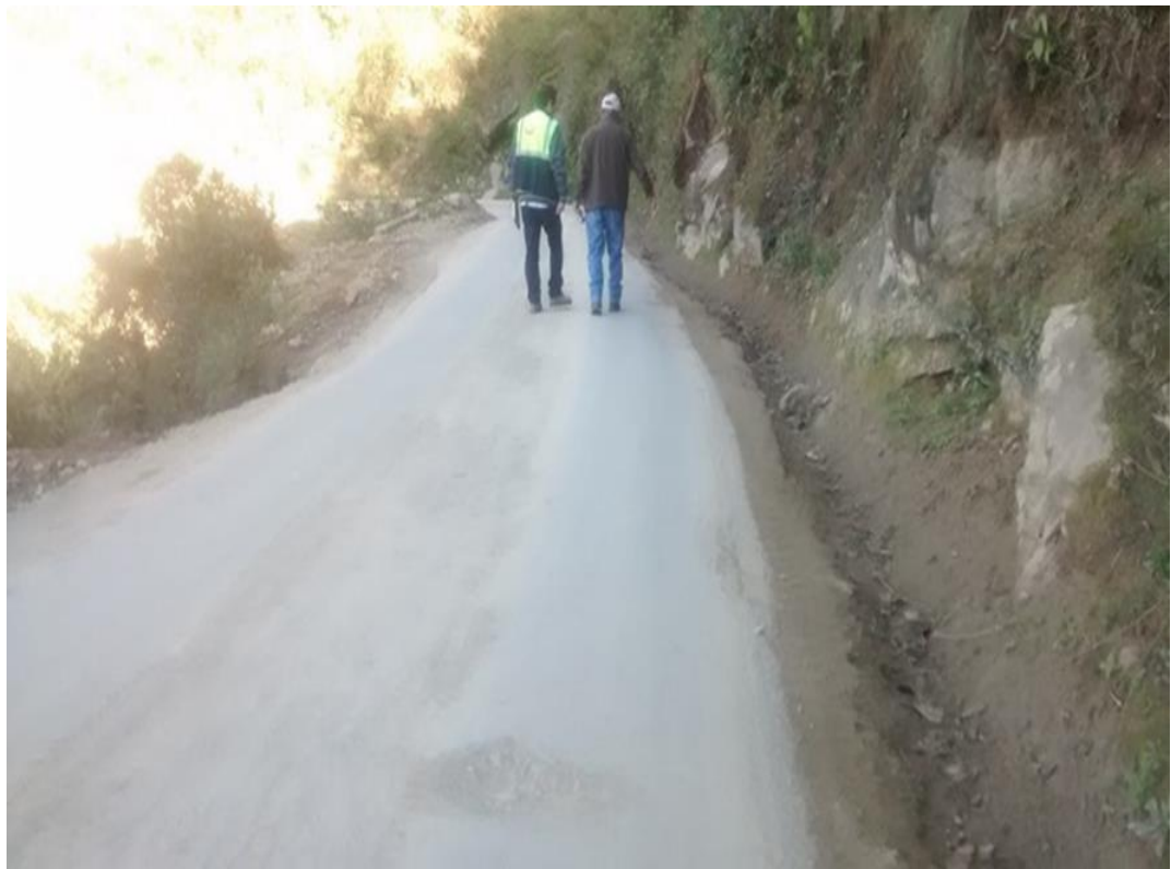
Fotografía N° 21 – Evaluación de cunetas sin revestir, Km. 98+200
