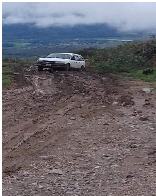
Fuente: Responsable de la investigación Estado actual luego de una lluvia (Carretera en estudio)
