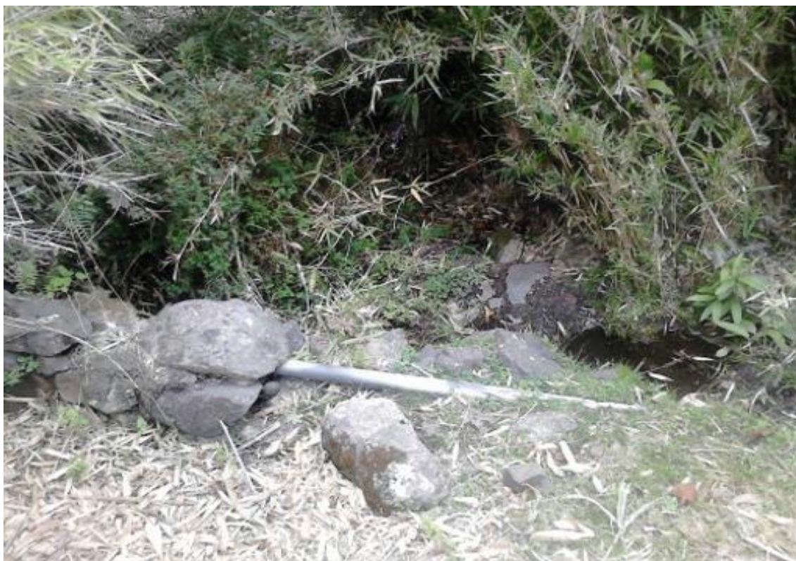
Foto N° 03 | Tuberías expuestas a menos de 0.30 m. de la línea de conducción.
