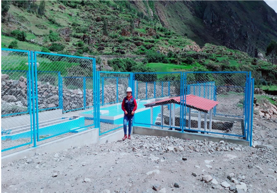
Foto N° 39 | Planta de tratamiento de aguas residuales N°02 en la localidad de Quitaracsa.
