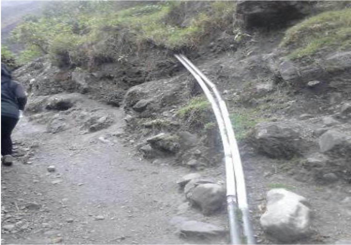
Foto N° 07 | Tuberías expuestas de la línea de conducción en mal estado.
