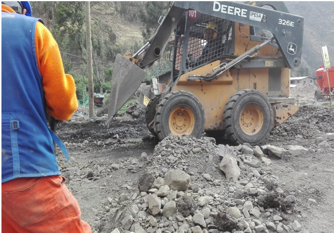
Foto N° 23 | Trabajo de la maquinaria en la excavación para el sistema de desagüe.
