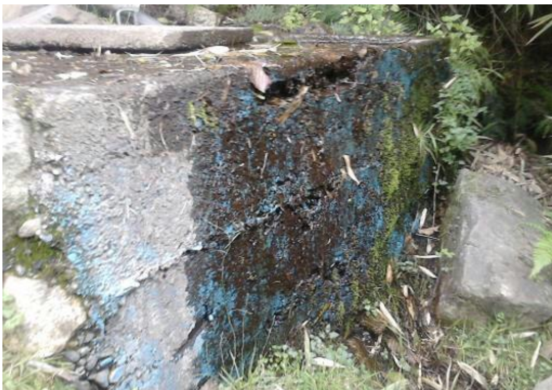
Foto N° 02 | Filtración de agua de la captación en la localidad de Quitaracsa.
