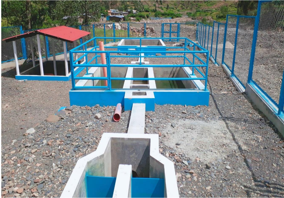
Foto N° 40 | Planta de tratamiento de aguas residuales N°01 en la localidad de Quitaracsa.
