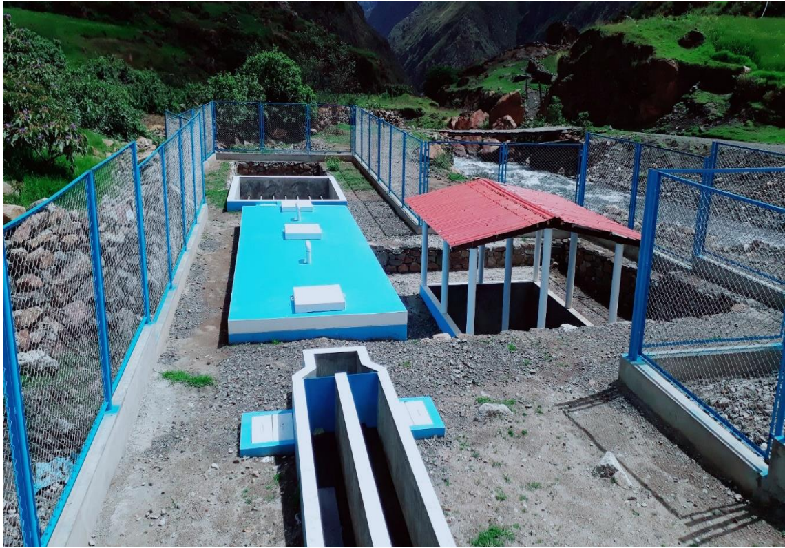
Foto N° 38 | Planta de tratamiento de aguas residuales N°03 en la localidad de Quitaracsa.
