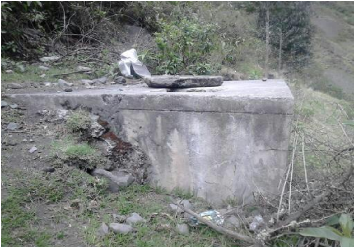
Foto N° 06 | Estado actual de la captación en deterioro.
