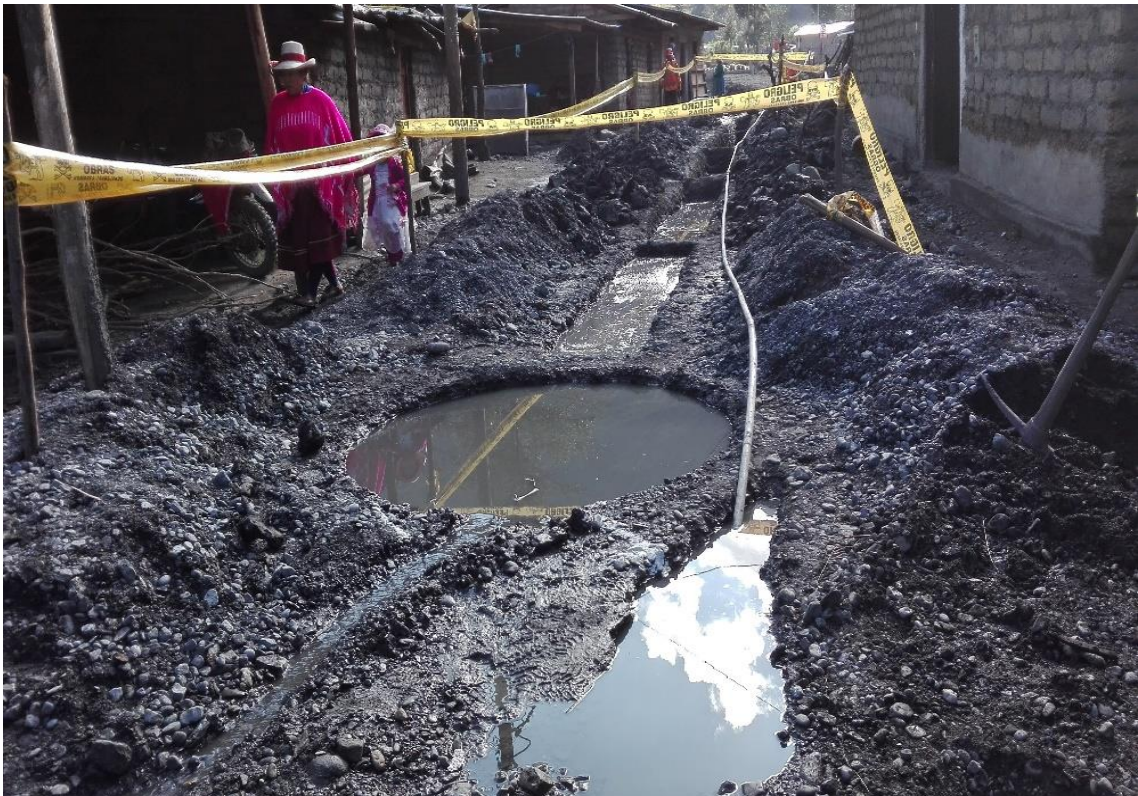
Foto N° 22 | Cámara de inspección de más de 1.00 mt de profundidad inundado.
