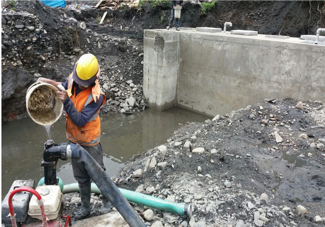
Foto N° 30 | Trabajo con la motobomba para facilitar el trabajo en la planta de tratamiento.
