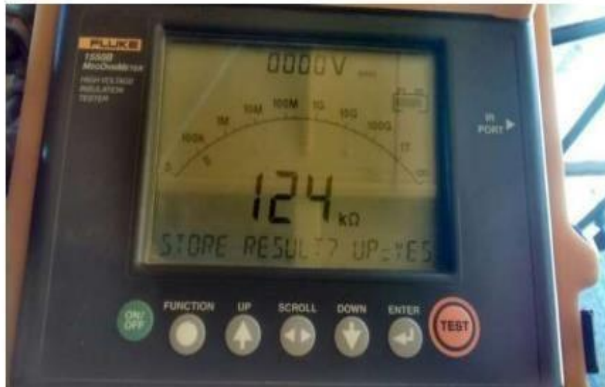
Bajo aislamiento de los cables trifásico T1, T2 y T3.
