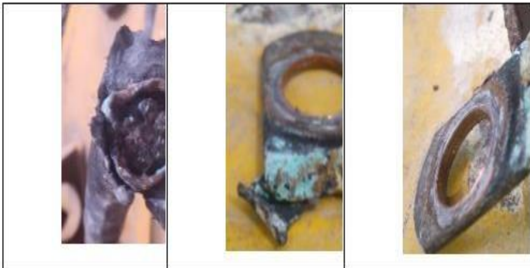
Figura 3 Estado del conjunto Cable y Terminal de alimentación al Blower RH
