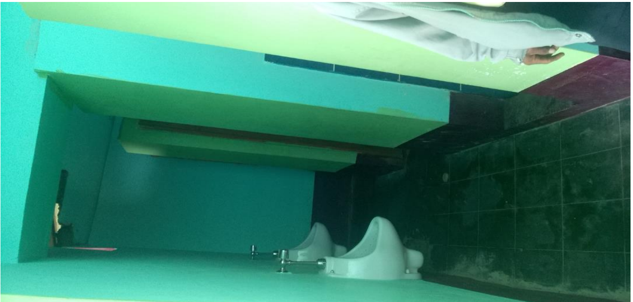
Figura 6: Servicios higiénicos en la I.E. 82138 - SURUAL
