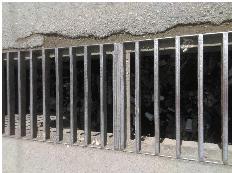
Ilustración 10 Alcantarillados de la ciudad,convertido en botadero clandestino y que obstruyen que el agua discurra sin dificultad
