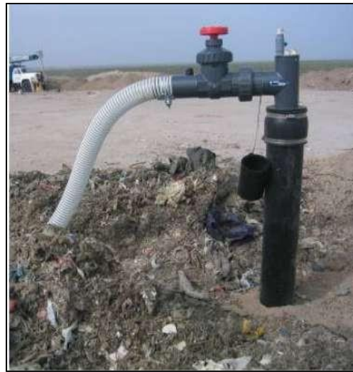
Ejemplo un pozo de extracción de biogás.
