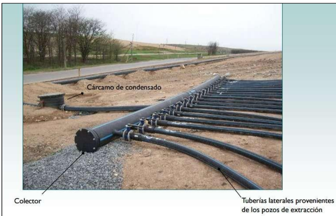
Tuberías colectoras de biogás.
