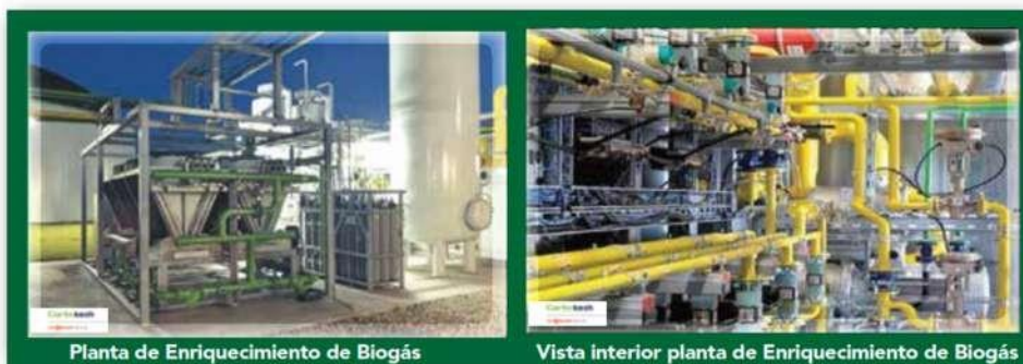
Proceso de enriquecimiento del biogás
