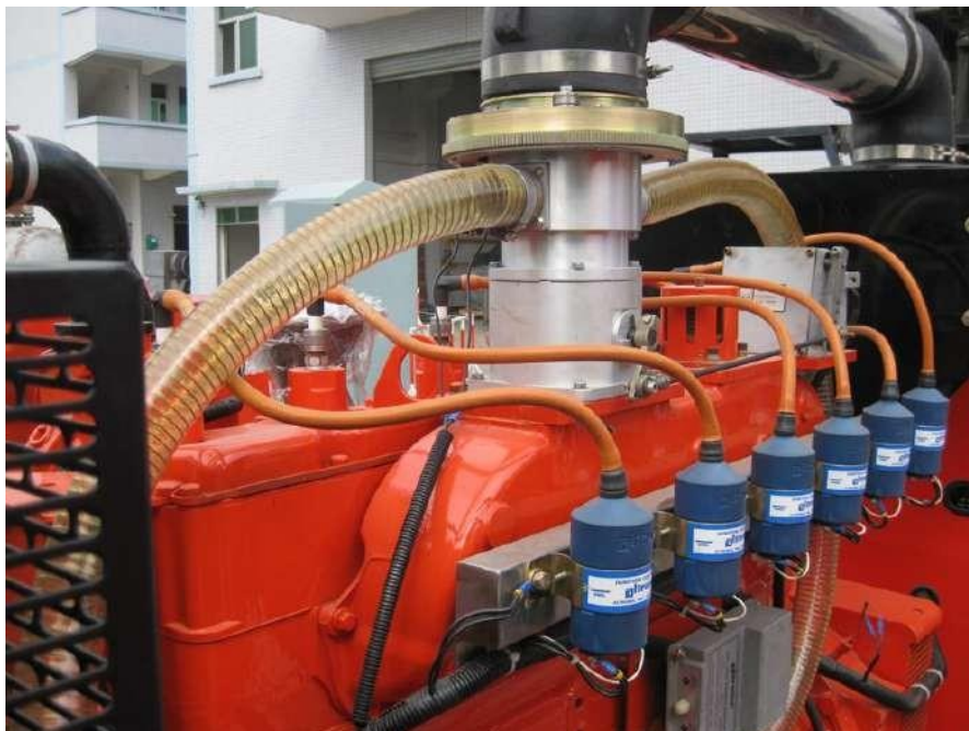
Grupo electrógeno CAMDA
